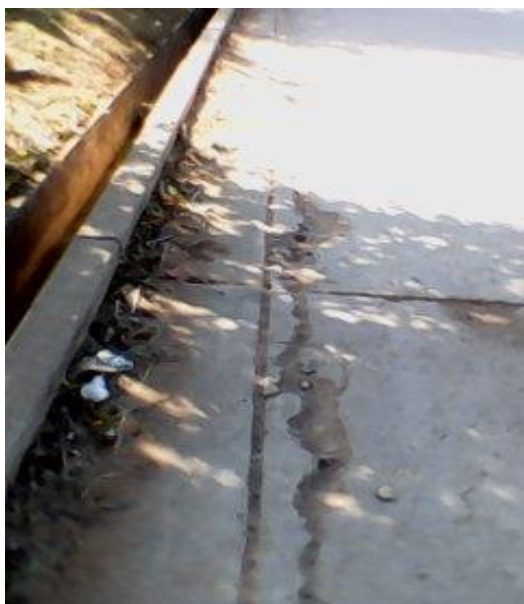
Fig. N° 06: Deterioros de grietas de esquina, cuadra 13.
