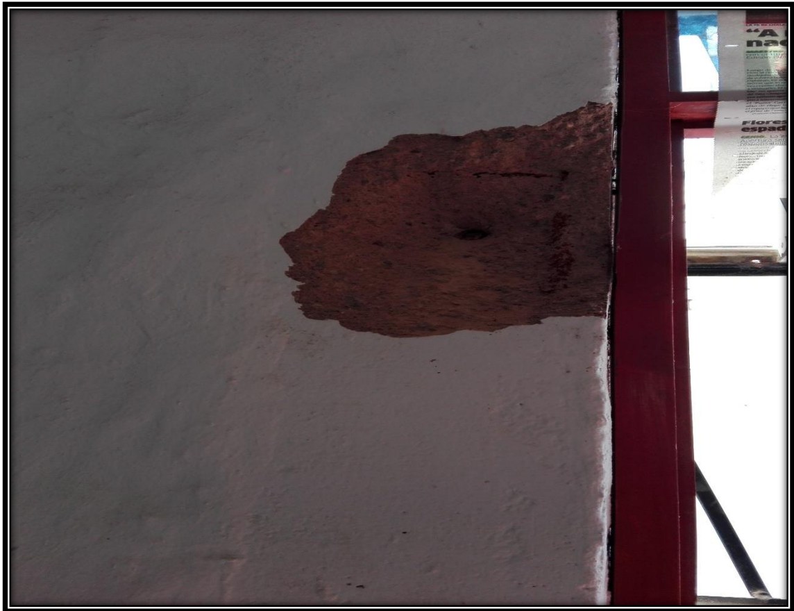
Figura 12: Fallas en columna en vivienda 06, a causa de una proporción pobre de cemento y agregados.
