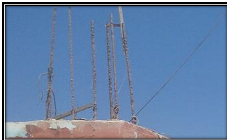
Figura 16: corrosión de acero en vivienda 04, debido a un inadecuado
