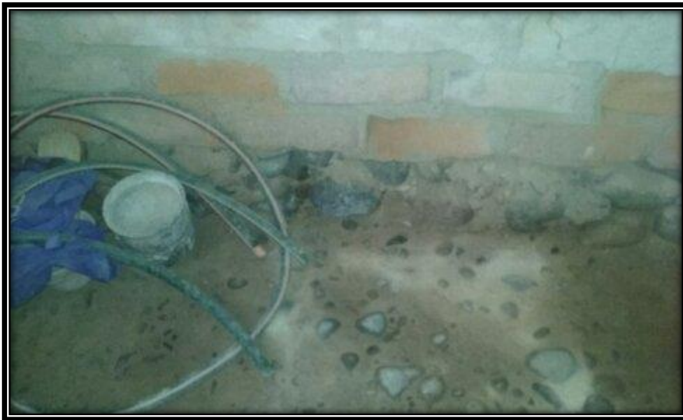
Figura 17: acción del salitre en vivienda 06, debido a que no se utilizó aditivos para mitigar este efecto durante el proceso de construcción.
