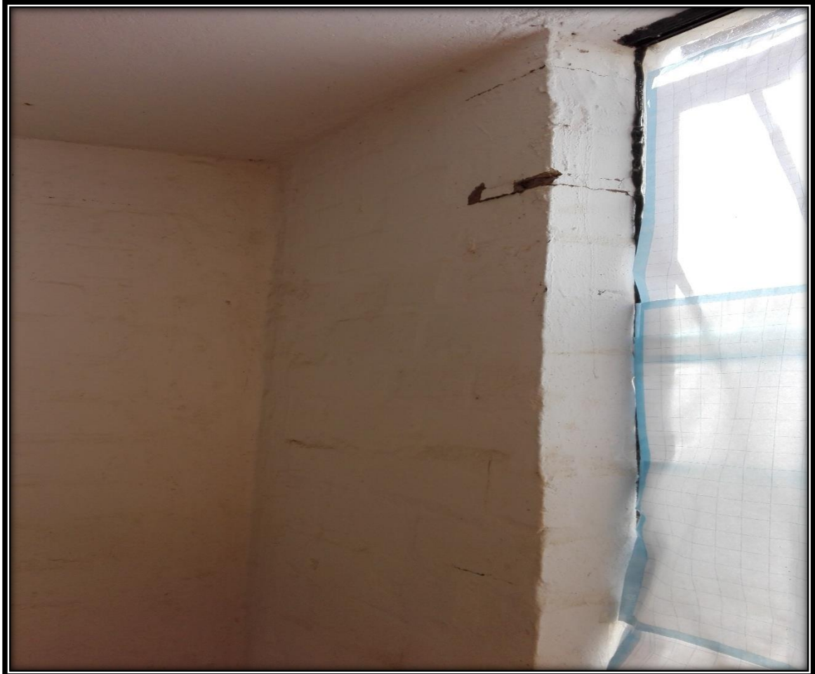
Figura 11: Fisura en muro en vivienda 06, al asentamiento del suelo.
