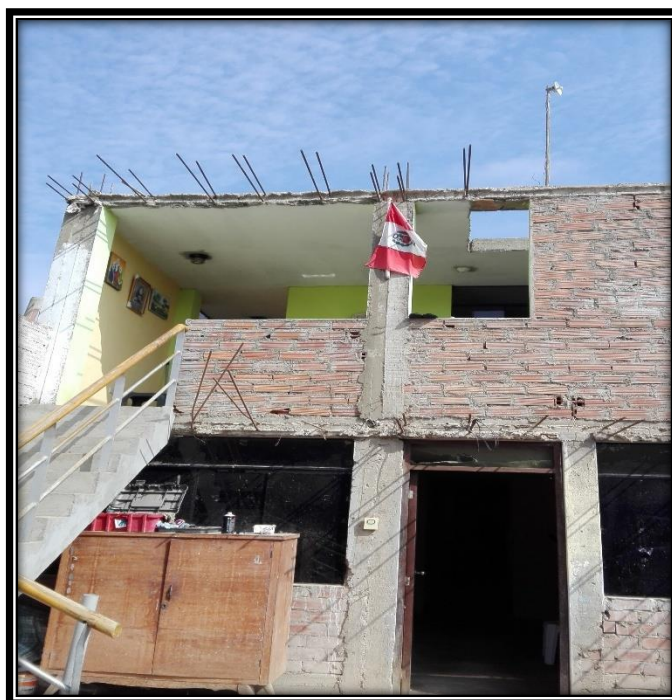
Figura 15: acero expuesto en vivienda 05, con lo cual producirá corrosión.
