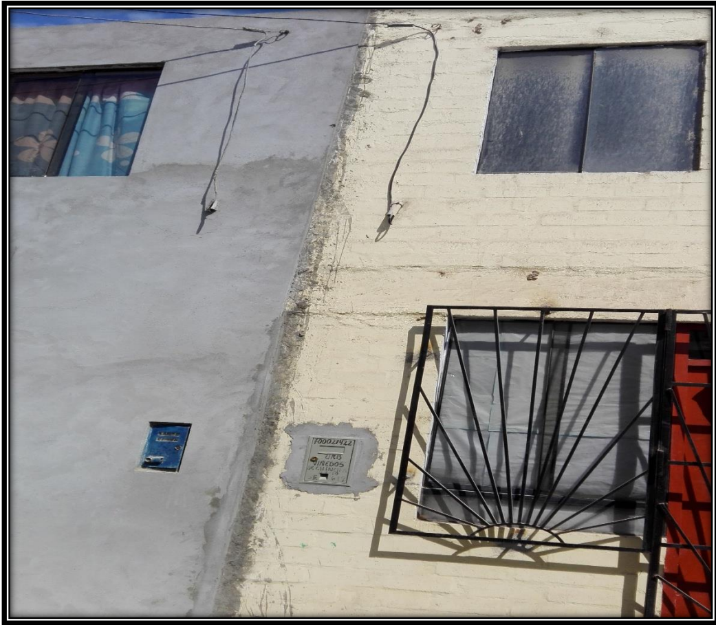
Figura 13: falta de juntas en vivienda 06, debido a un inadecuado proceso constructivo y supervisión.
