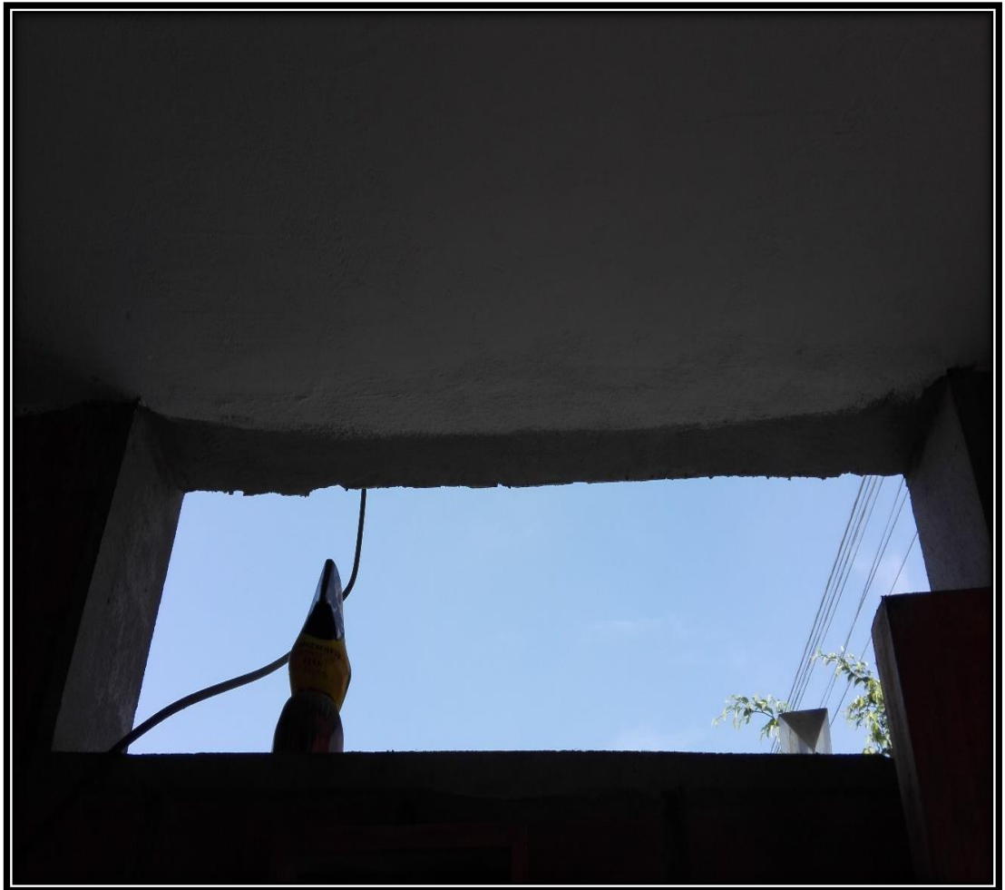
Figura 14: abertura en muro portante en vivienda 05, lo cual genera columnas corta, por la falta de asesoría profesional al dueño de la vivienda.
