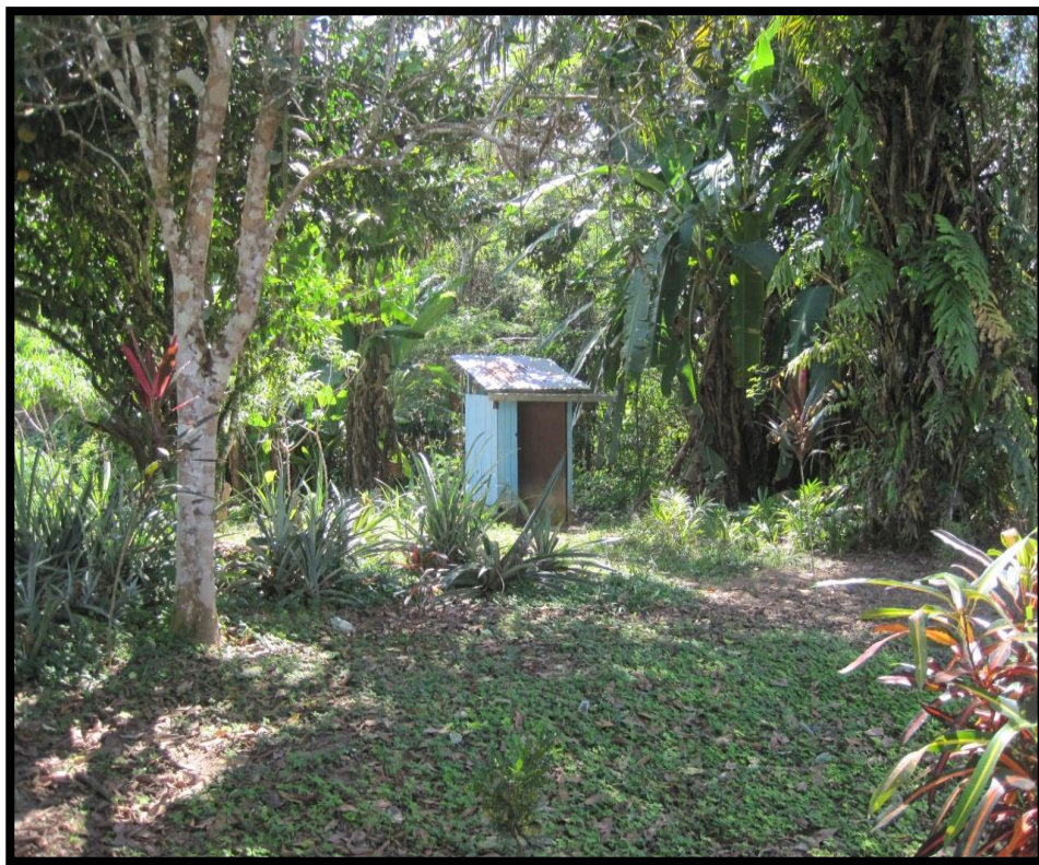
Fotografía N° 03: Letrina en mal estado CCNN Enoc de Flor de un Día.
