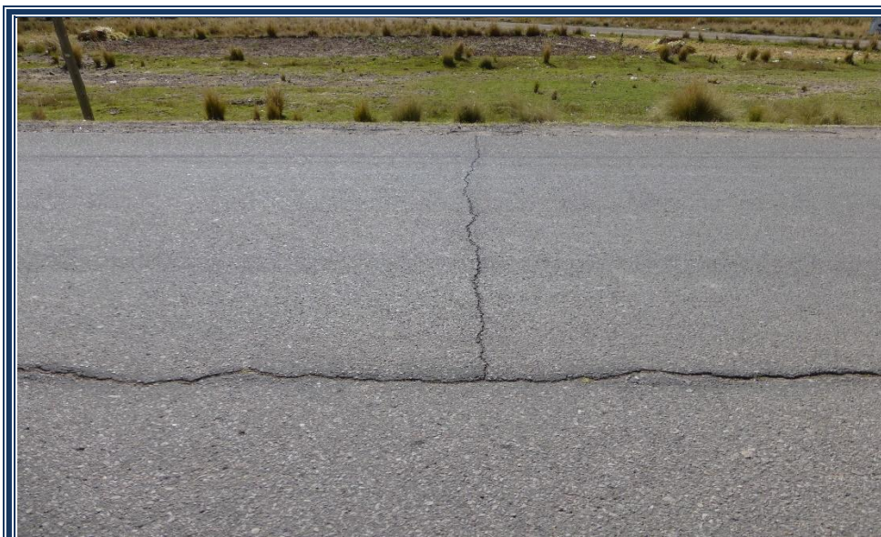
FOTOGRAFIA N° 07 TRAMO JULIACA LAMPA EVALUANDO PA LA PARTE FUNCIONAL EN DONDE SE LAS GRIETAS EN
