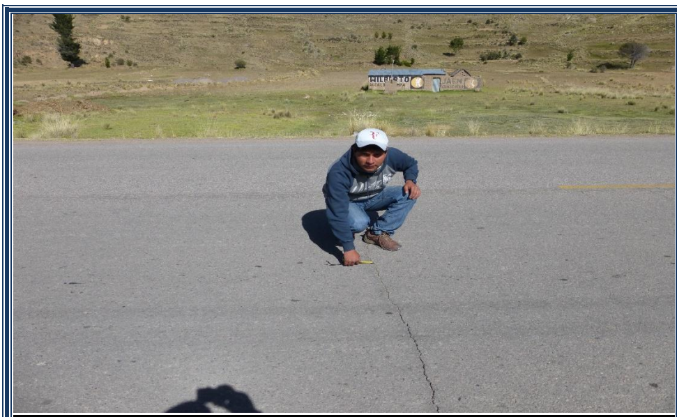
FOTOGRAFIA N° 09 TRAMO JULIACA LAMPA EVALUANDO PA LA PARTE FUNCIONAL EN DONDE SE REALIZA LAS MEDICIONES DE LAS FISURAS EN EL PAVIMENTO FLEXIBLE
