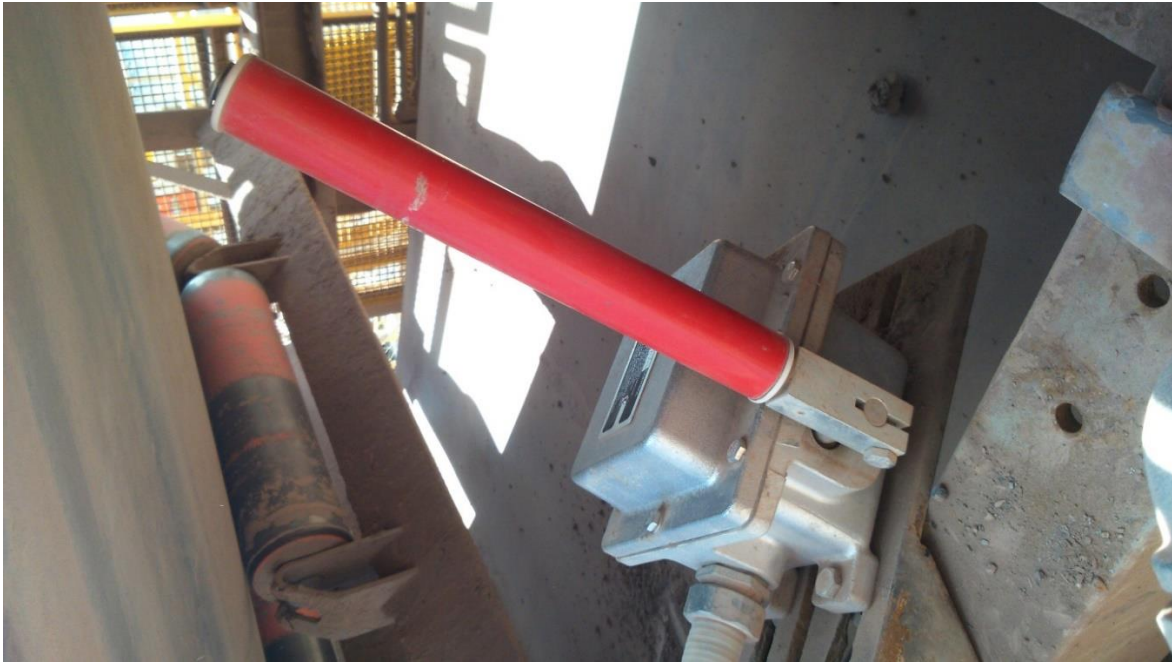
Anexo 13. Travel Switch
