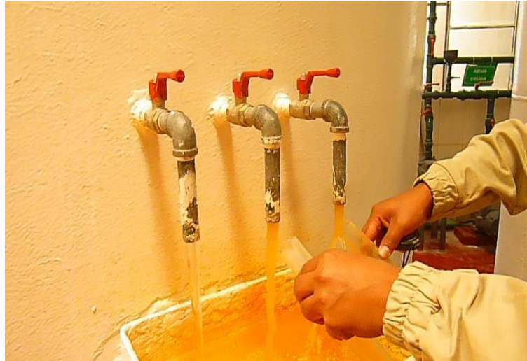
Figura 7 Medición De Floccs Del Tanque Reactor
