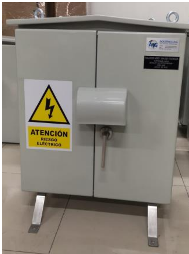
Figura 32. Tablero de distribución con sensor de apertura de puerta
