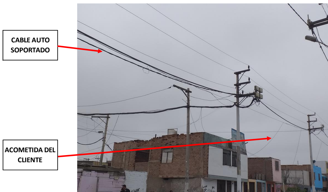
Figura 20. Cable matriz Auto soportado y acometida que se cambiara en el proyecto
