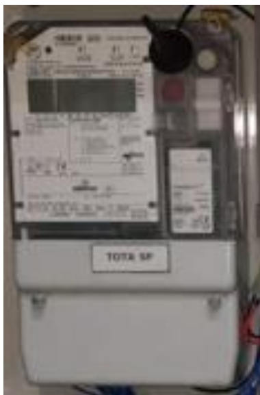
Figura 8. Medidor Multifunción Totalizador
