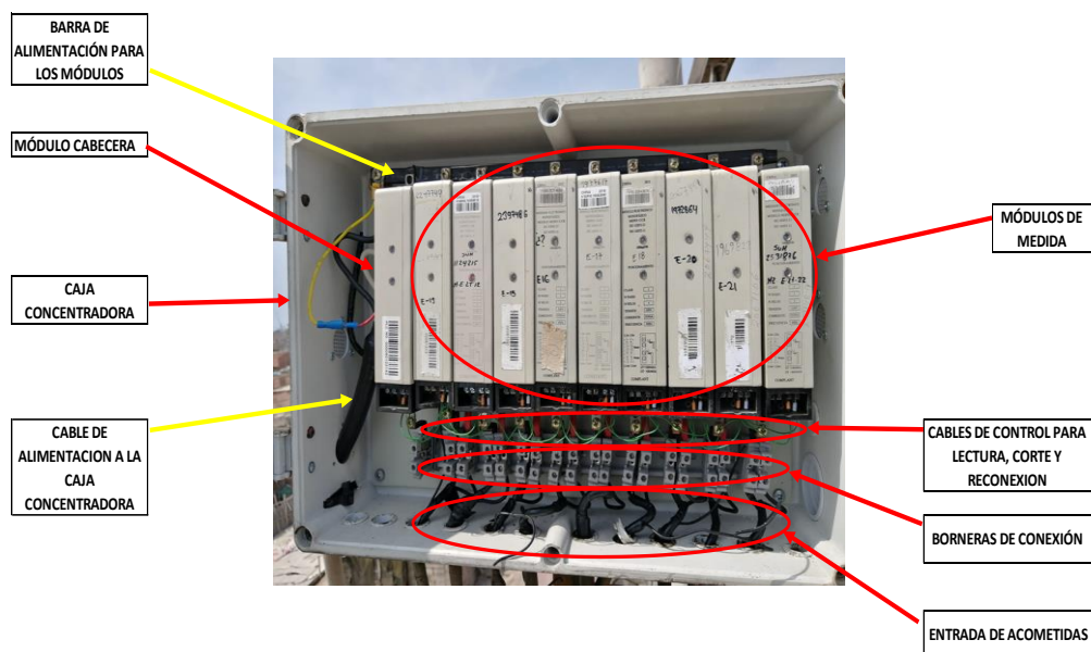
Figura 22. Instalación de la caja concentradora actual.
