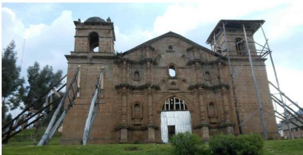
Figura 10 Imafrente de la Iglesia de San Martín de Haqira. Los apuntalamientos provisionales patentizan el deterioro que amenaza a la construcción.
