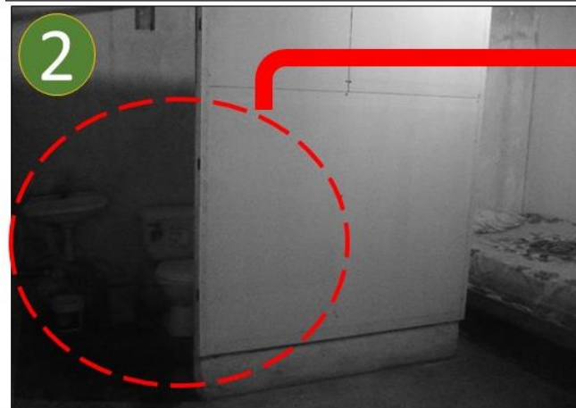
Imagen 11. Vista referencial del interior del cuarto, inadecuada accesibilidad Fuente: Propia(Agosto 2016)
