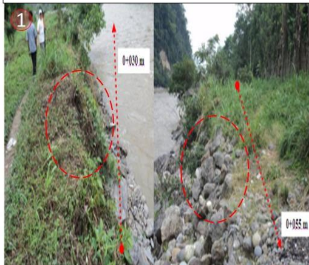
Imagen 6. Dique en mal estado con poca altura en su trecho, no cubre el desnivel. Fuente: Municipalidad provincial Leoncio prado Disponibile: http://www.munitingomaria.gob.pe/mplp/
