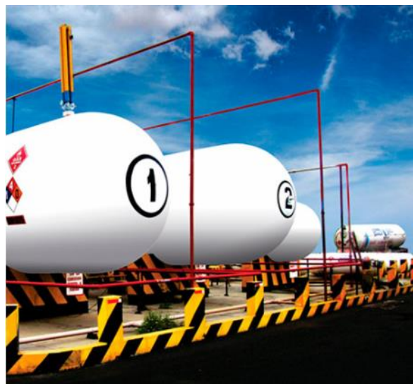
Ilustración 5. Instalaciones de redes de GLP
