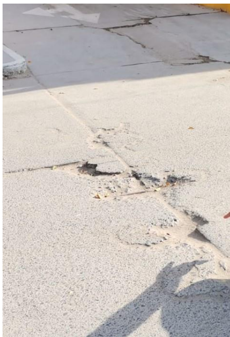
Imagen N° 14: Fisura por mal funcionamiento de juntas
