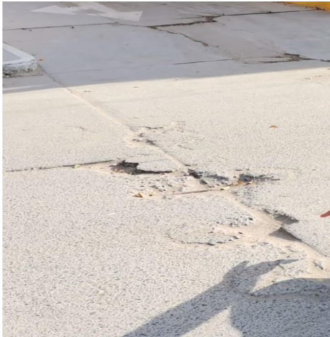
Imagen N°04: Deterioro del sello de junta FUENTE: Propia
