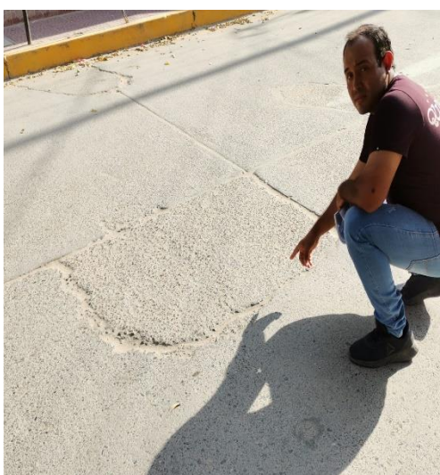
Imagen N° 12: Fisura de esquina
