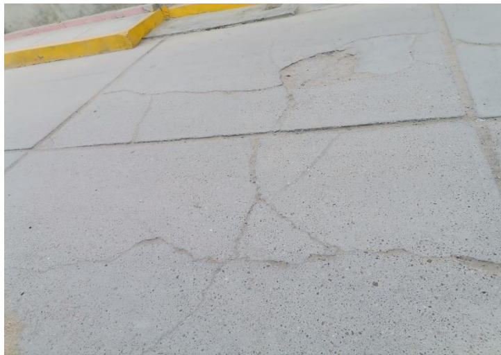
Imagen N°05: Fisura de reflexion de junta FUENTE: Propia
