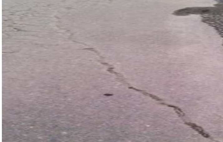
Imagen N°06: Fisura parabólica FUENTE: (Rodríguez, 2009)
