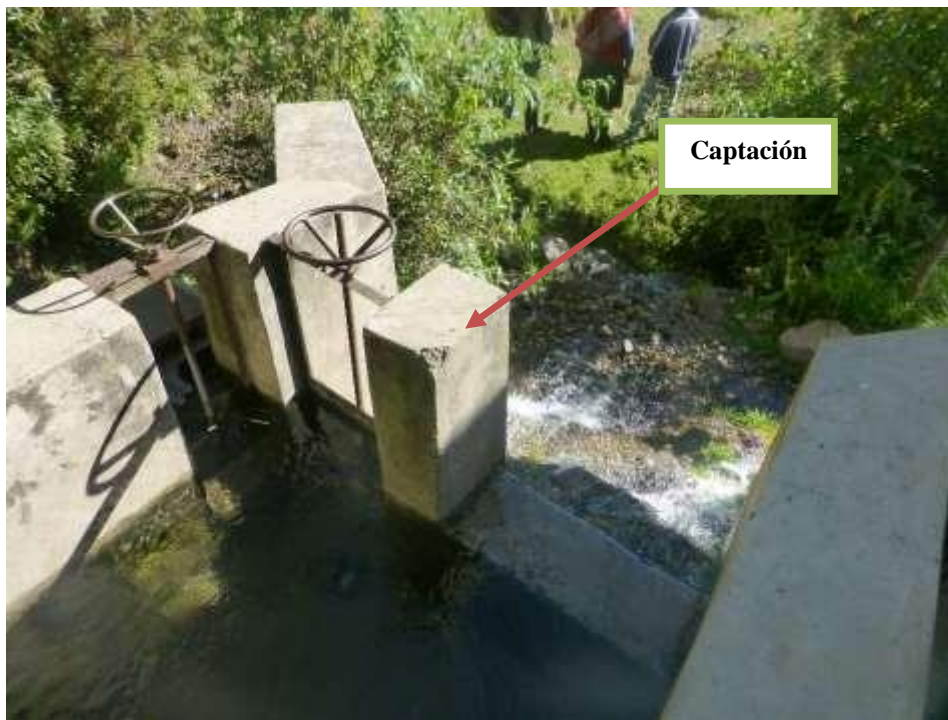
Figura 03: Ubicación de la captación
