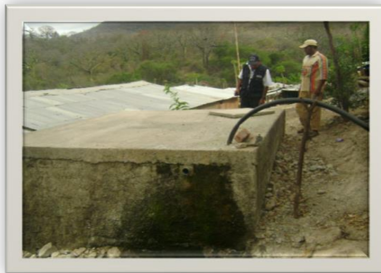
FOTO N° 08: Saneamiento Básico. Reservorio de agua.
