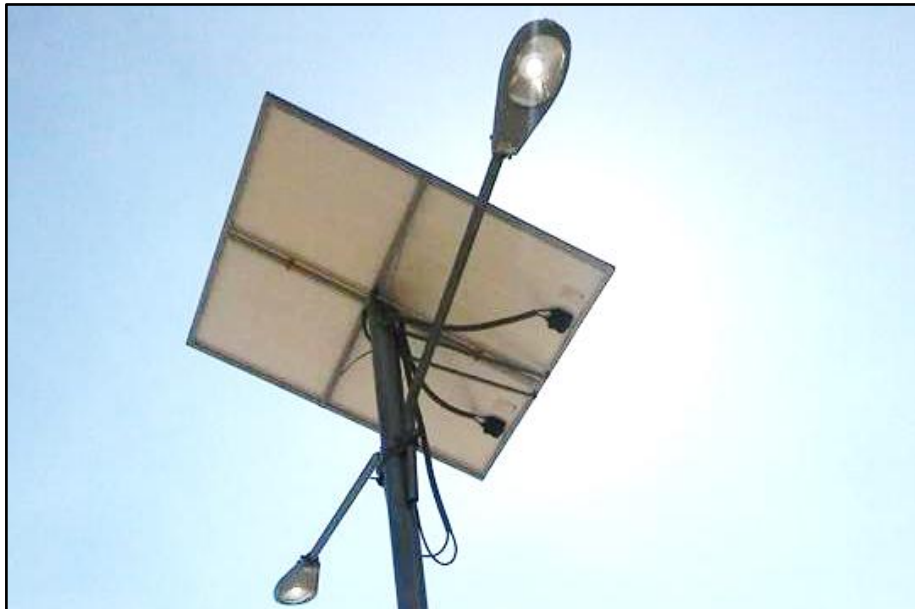
Figura 82: Paneles solares y luminarias LED instaladas en el poste solar
