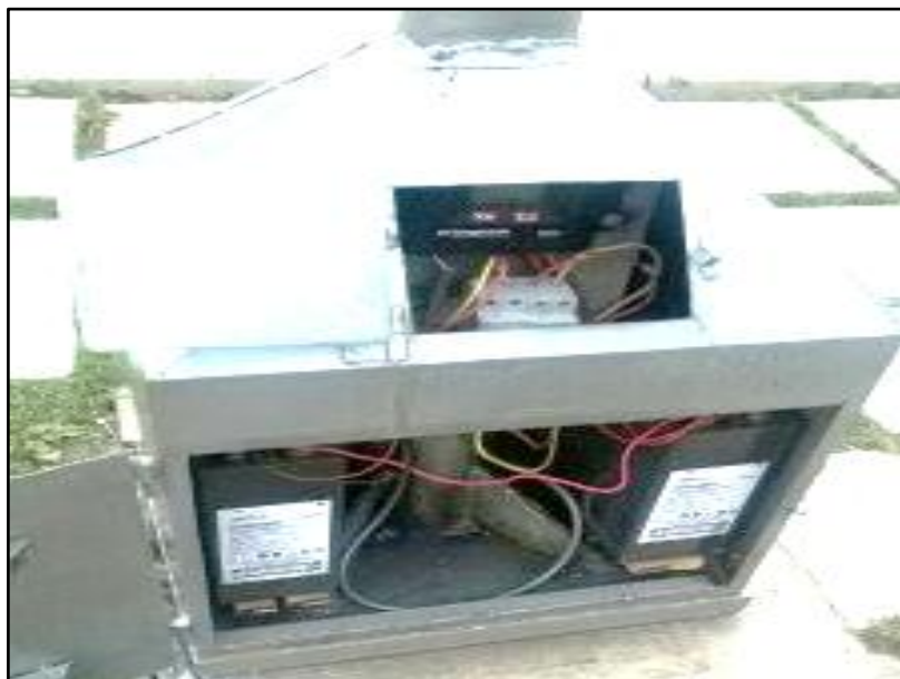
Figura 83: Baterías, controlador de carga y accesorios en la base del poste solar
