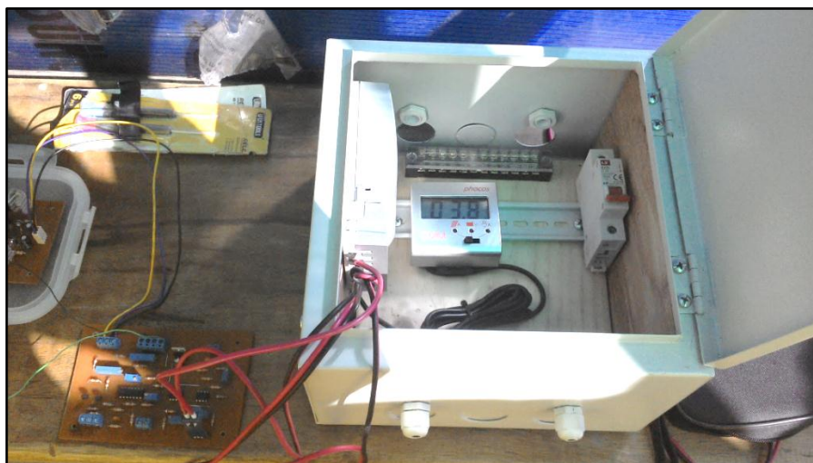
Figura 85: Componentes del sistema de monitoreo de potencia generada
