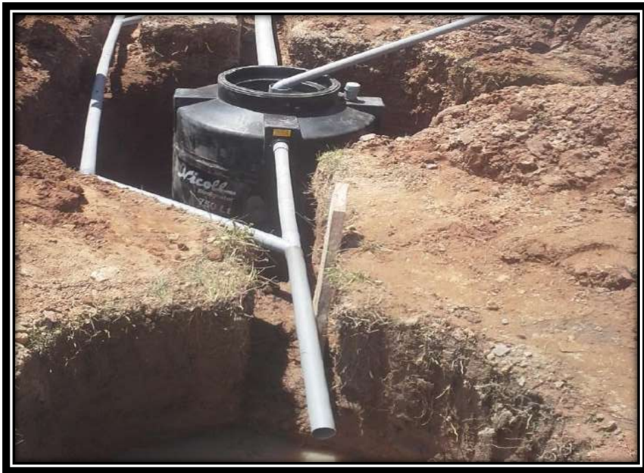
FOTOGRAFIA N° 13- REALIZANDO EL FUNCIONAMIENTO DEL BIODIGESTOR
