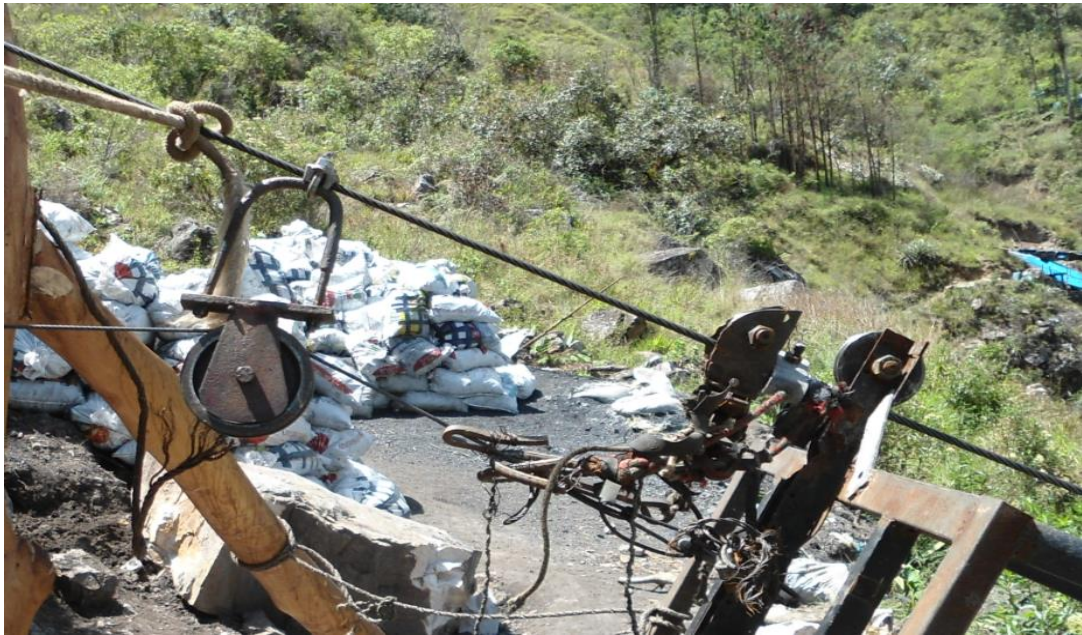
Figura 61. Poleas, Cable Tensor, Cable Fijo 1/2" Fuente: Elaboración propia, 2017.
