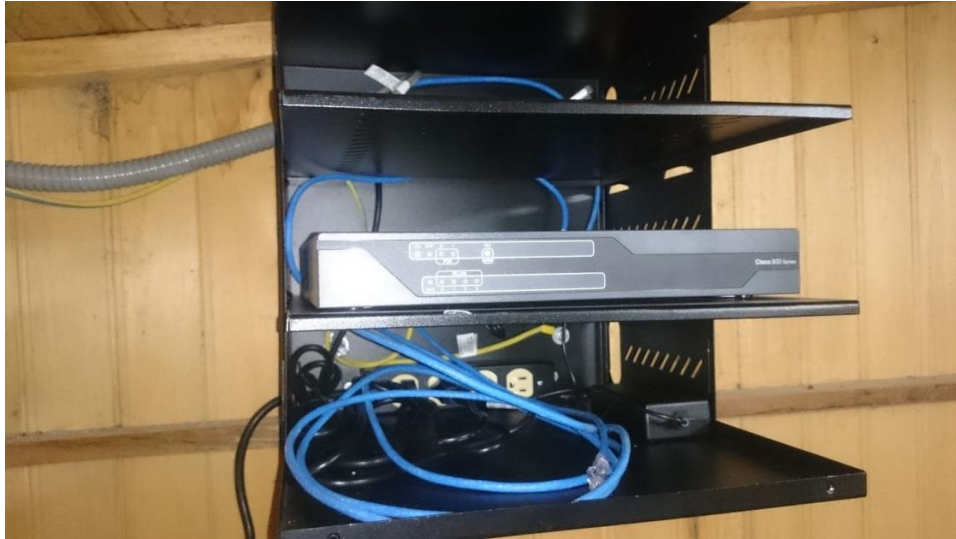
Foto 20: Vista del gabinete de Tx.
