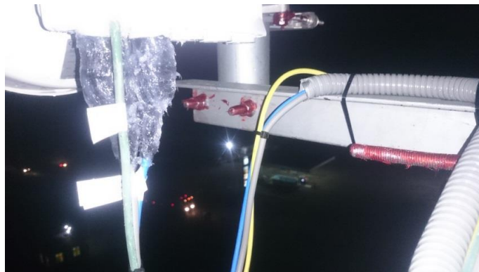
Foto 5: Vista de conexiones a ODU, etiquetado, engrasado de pernería.
