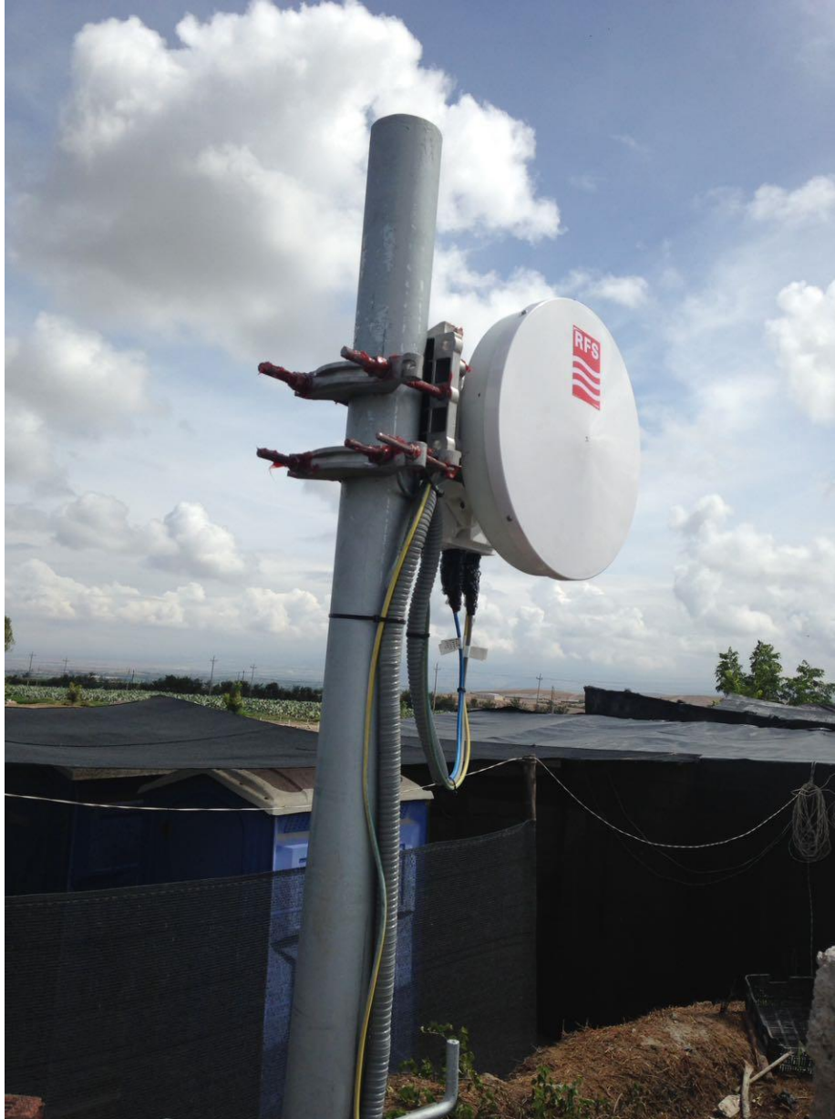
Foto 13: Vista de la antena instalada en lado Cliente.
