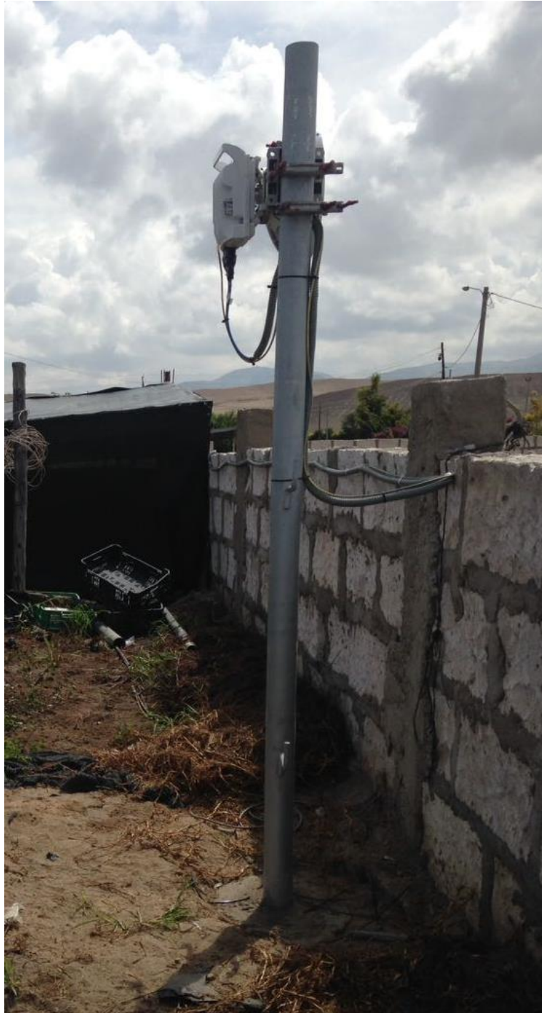
Foto 14: Vista del soporte de antena y ODU instalada.
