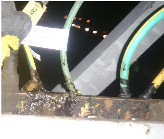
Foto 6: Vista de aterramiento y etiquetado en Site.
