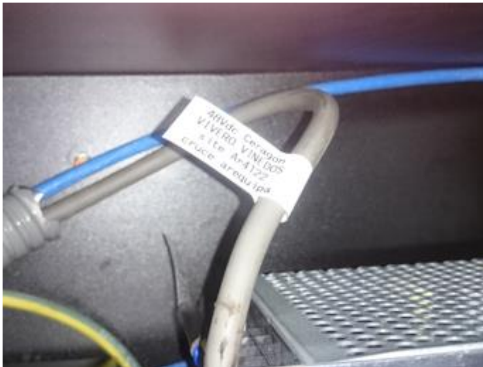
Foto 24: Etiquetado de energía del equipo de radio.
