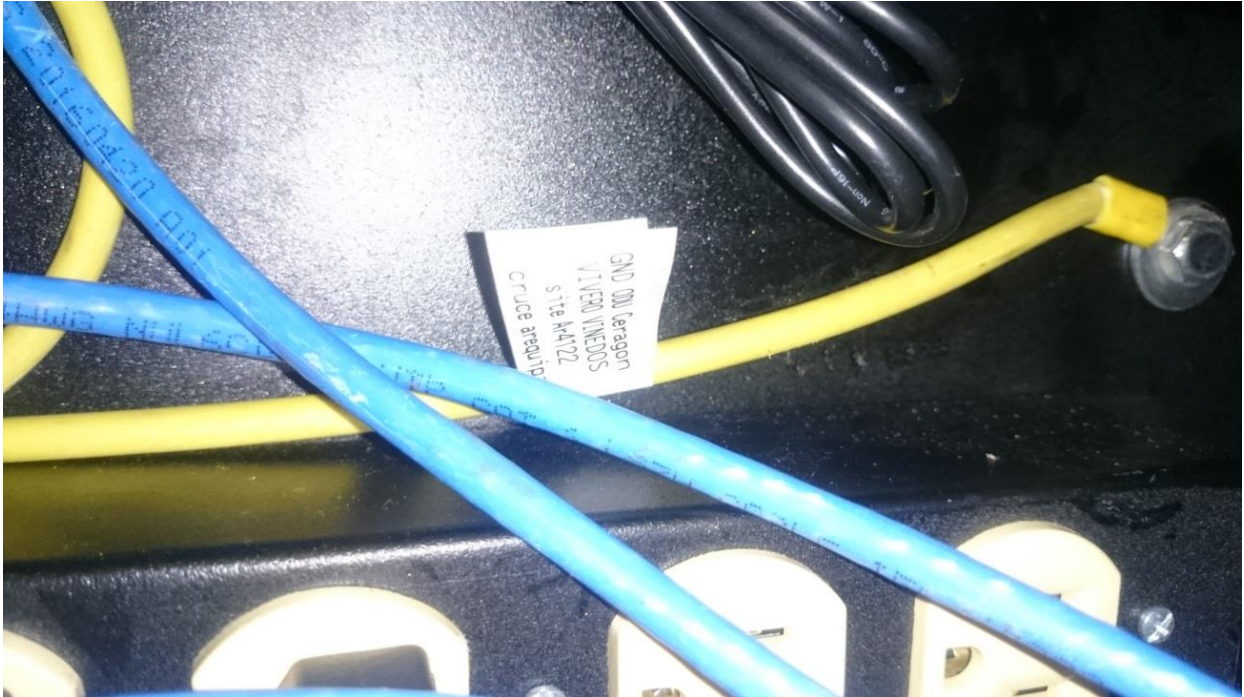
Foto 18: Vista de aterramiento y etiquetado lado Cliente.
