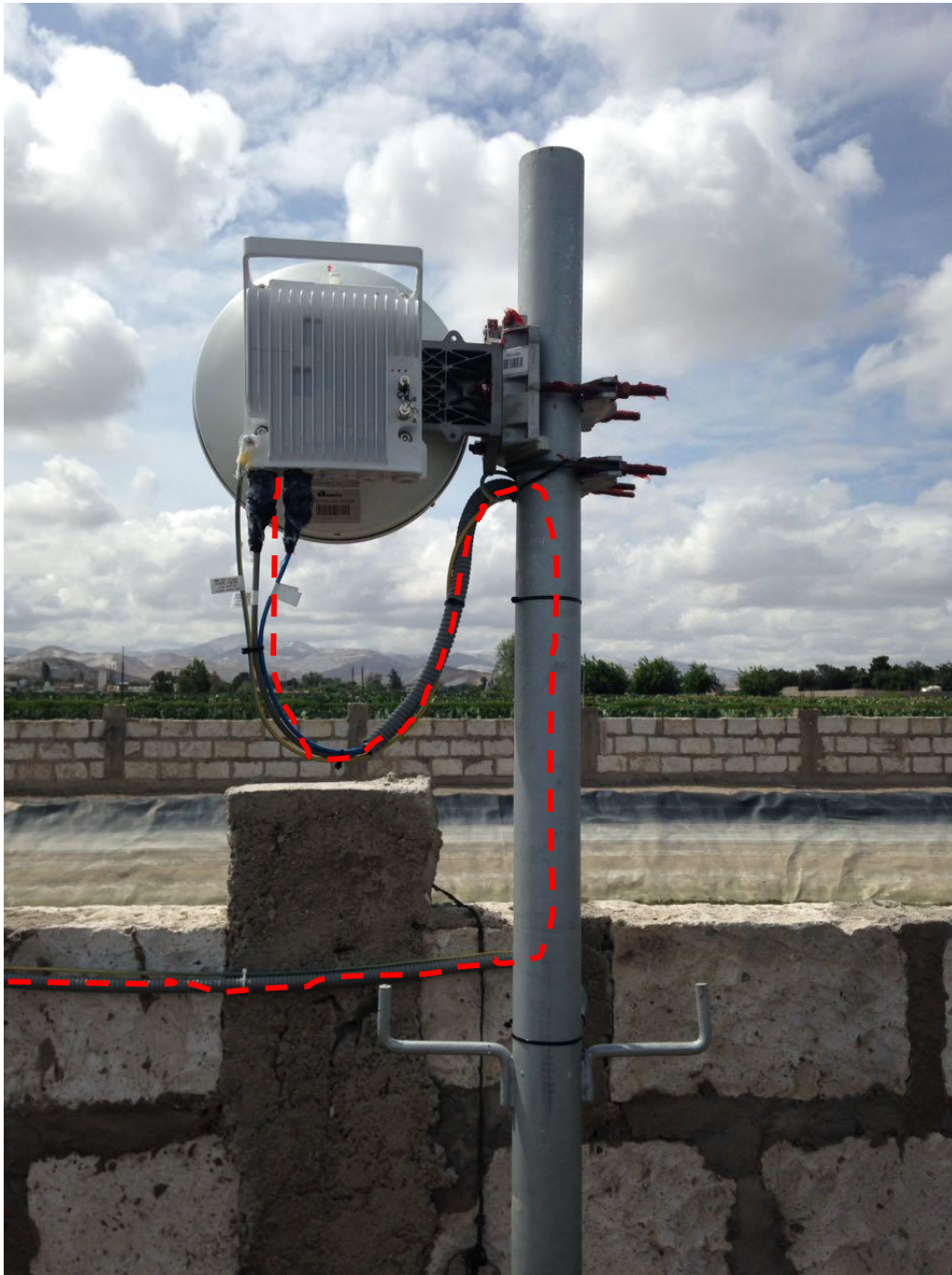
Foto 19: Recorrido de cableado desde antena hasta la entrada al gabinete de Tx.
