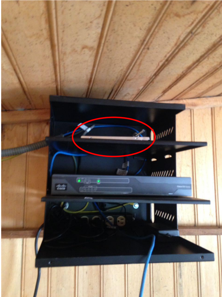
Foto 22: Vista de fuente AC/DC.
