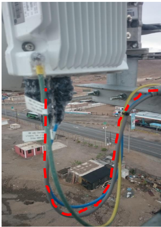
Foto 7: Recorrido de cableado desde antena hasta la entrada al gabinete de Tx.
