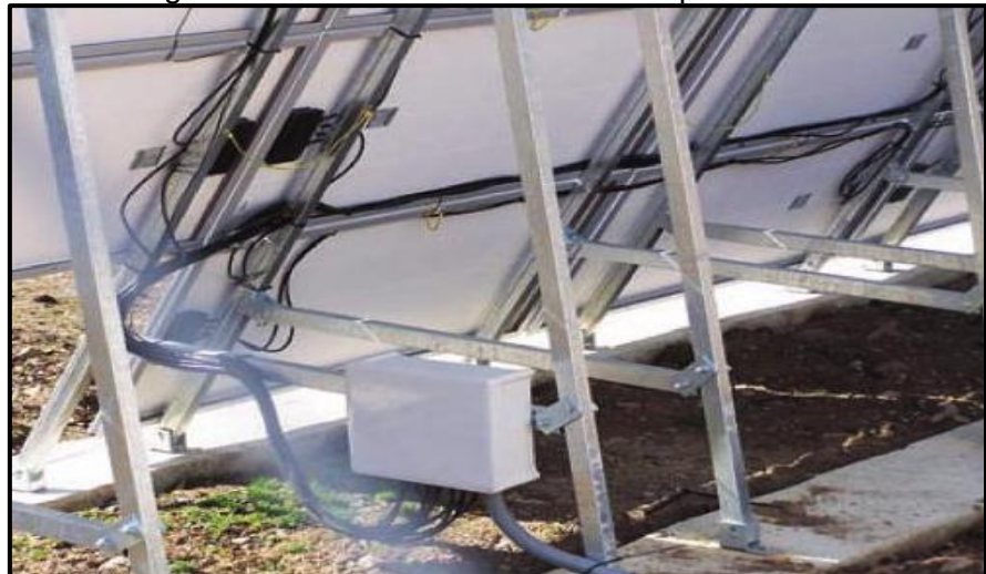
Figura 2.3. Conexiones exteriores de paneles fotovoltaicos
