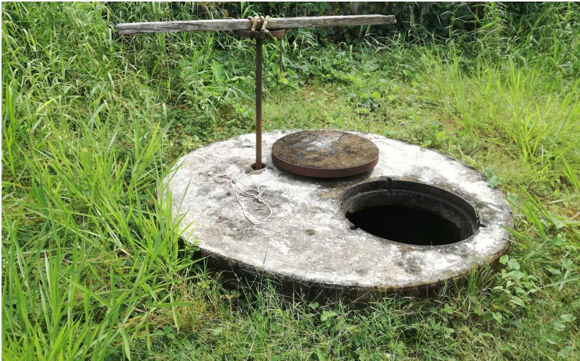
Imagen 20: Vista de la Cámara de Rejas
