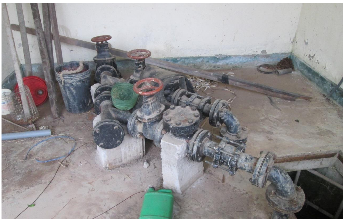
Imagen 19: Estado Actual del Sistema de Bombeo – Cámara de Bombeo de Desagüe Existente N°02
