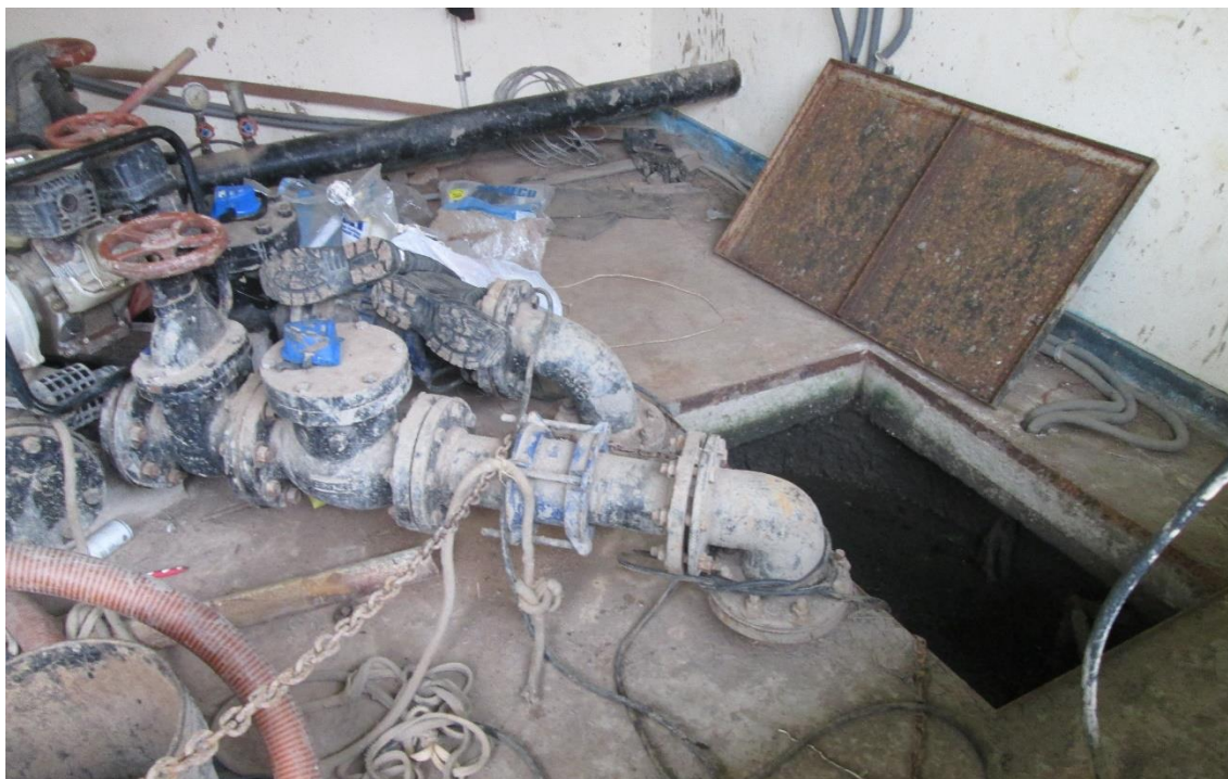
Imagen 16: Estado Actual del Sistema de Bombeo – Cámara de Bombeo de Desagüe Existente N°01
