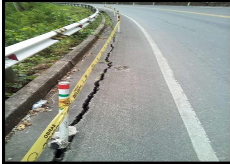
Foto N° 10: Fisuras en la berma, gravedad 1.
