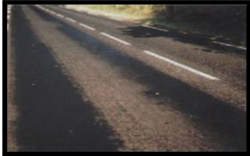
Figura N° 17: Gravedad 3 (Fuente: Manual de carreteras, conservación vial del MTC 2013)
