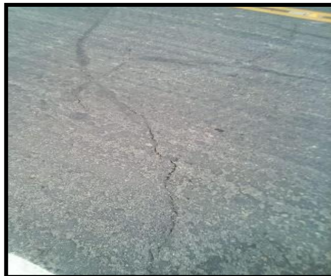
Foto N° 08: Fisuras transversales, gravedad 1.
