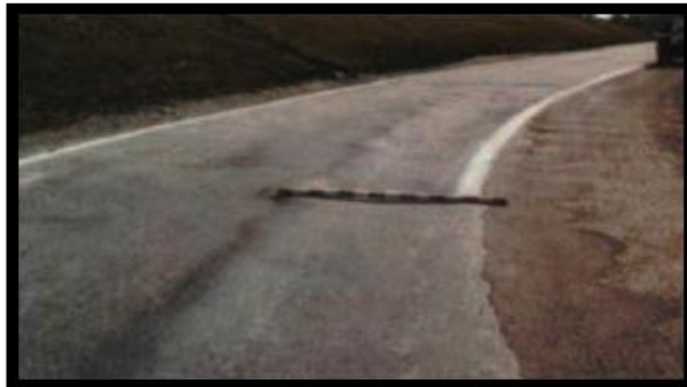
Figura N° 10: Gravedad 3 (Fuente: Manual de carreteras, conservación vial del MTC 2013.)
