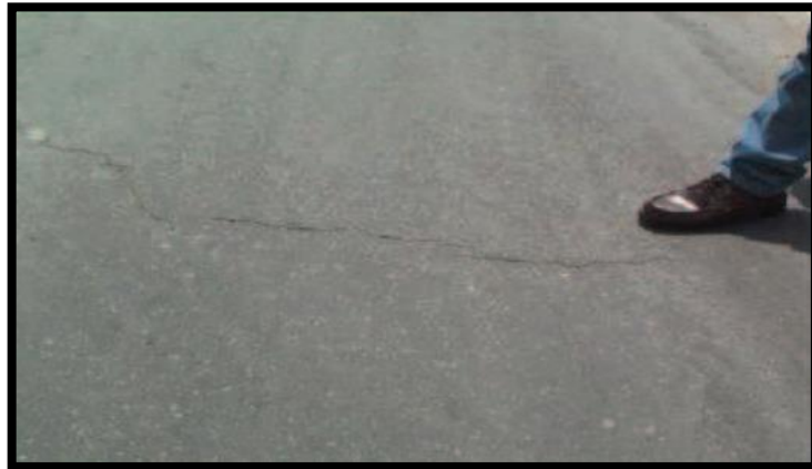
Figura N°15: Gravedad 1 (Fuente: Manual de carreteras, conservación vial del MTC 2013)
