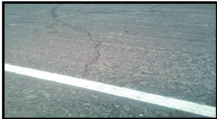
Foto N° 01: Fisuras Longitudinales, gravedad 1.
