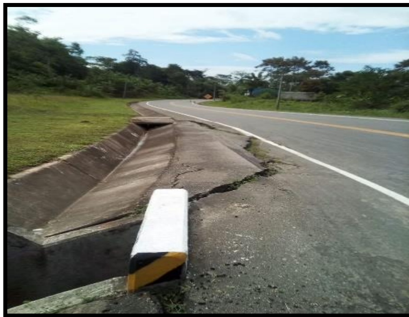
Foto N° 09: Fisuras en la berma, gravedad 1.
