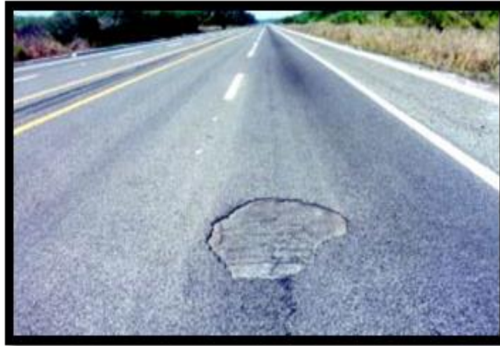
Figura 12: Gravedad 2 (Fuente: Catálogo de deterioros de pavimentos flexibles)
