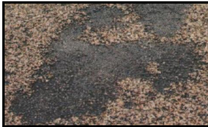
Figura 13: Gravedad 3 (Fuente: Manual de carreteras, conservación vial del MTC 2013.)
