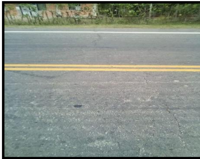
Foto N° 07: Fisuras transversales, gravedad 1.
