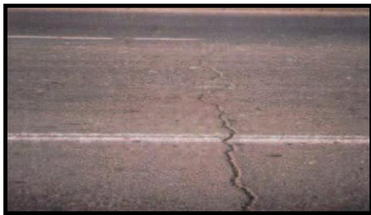
Figura N° 16: Gravedad 2 (Fuente: Manual de carreteras, conservación vial del MTC 2013)
