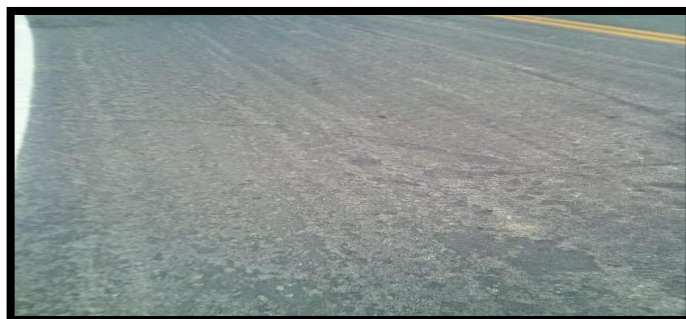
Foto N° 02: Fisuras Longitudinales, gravedad 2.
