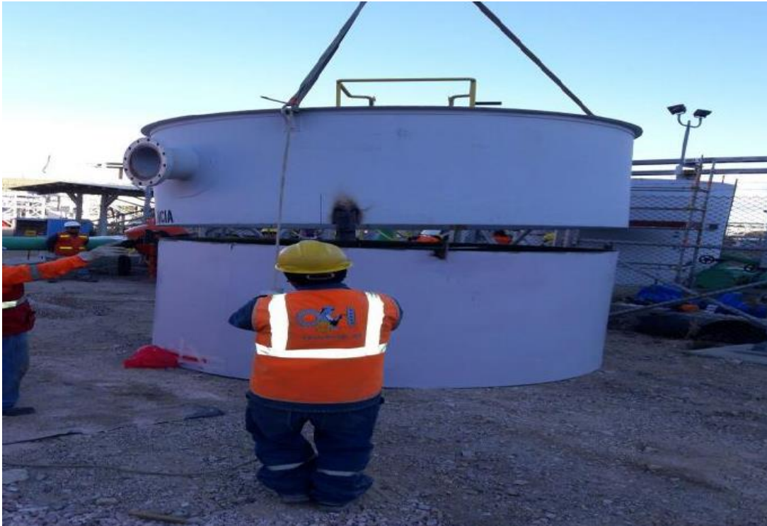
Figura 3.3.5 Tanque pulmón antes del aumento de anillo metálico Fuente: Informe de cálculo de estación de re bombeo de Minera Yanacocha
