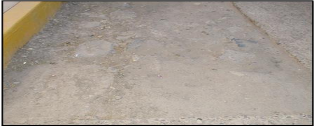
Ilustración 7 FALLA POR DESINTEGRACION
