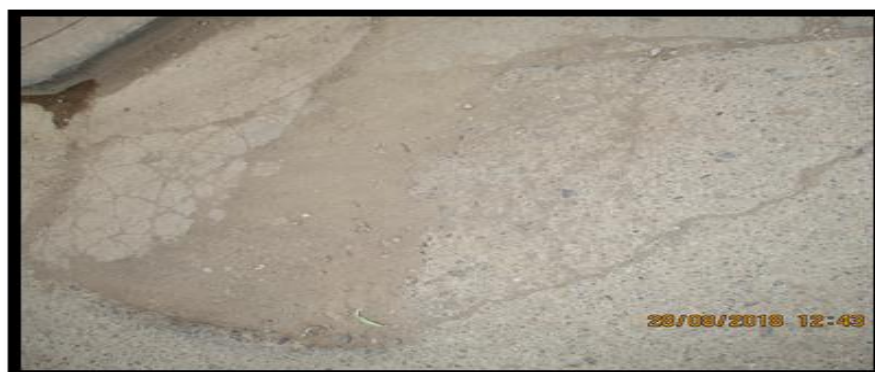
Ilustración 4 FALLA POR PUNSONAMIENTO
