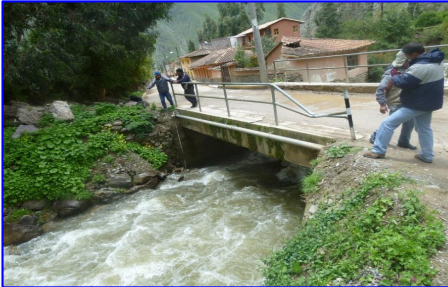
Foto 04. Puente Patacancha (con Luz insuficiente para evacuar caudal de crecida)
