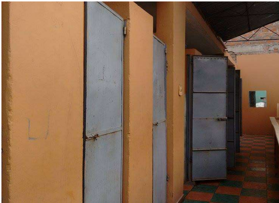
Bateria de baños, muy reducidos y en mal estado.
