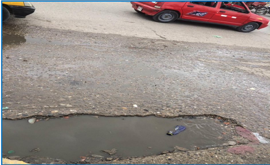
Fotografía N° 1: Rotura de tubería de alcantarillado ocasionando aniegos de aguas residuales en Av. Mariscal Castilla
