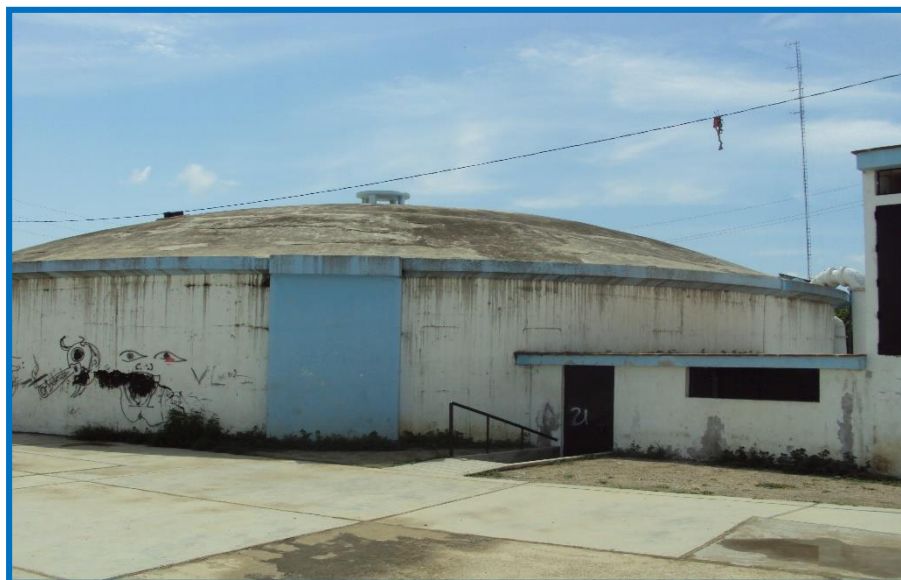
Fotografía N° 9: Reservorio ubicado en el Barrio El Tablazo
