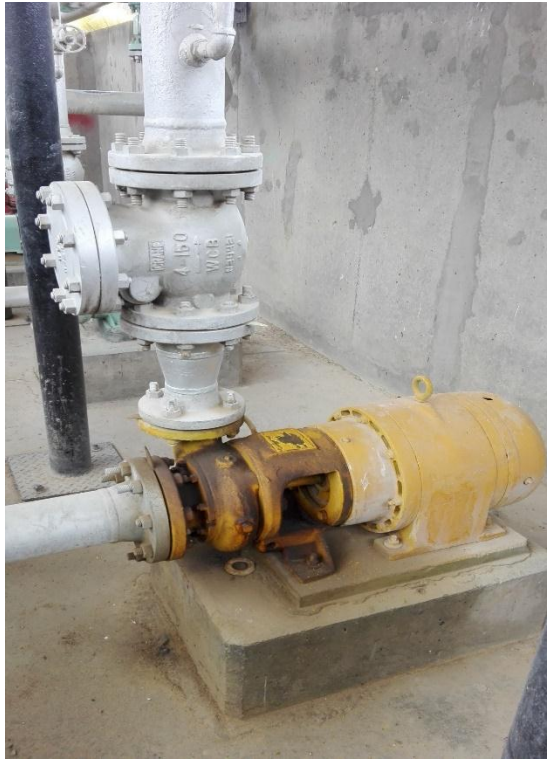
ANEXO 15: Electrobomba centrífuga ingersoll-rand N° 1
