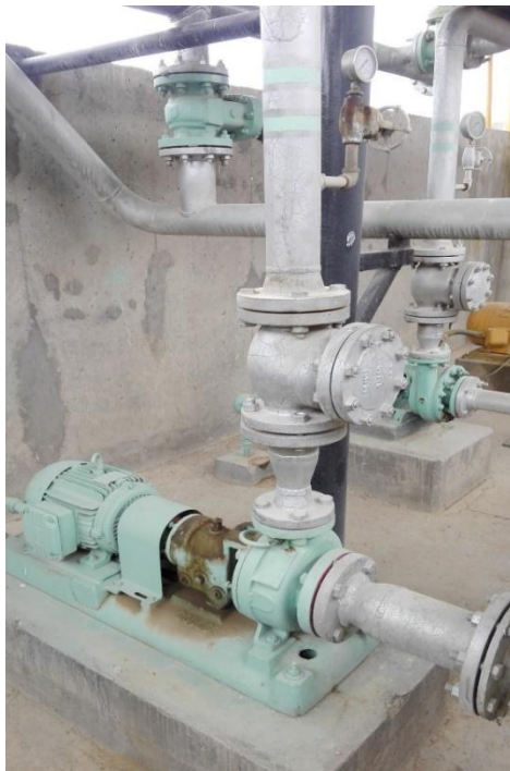
ANEXO 18: Electrobomba centrifuga ingersoll-rand N° 4
