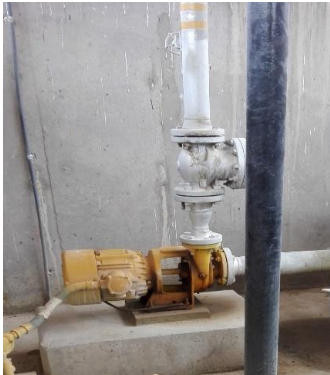
ANEXO 16: Electrobomba centrífuga ingersoll-rand N° 2
