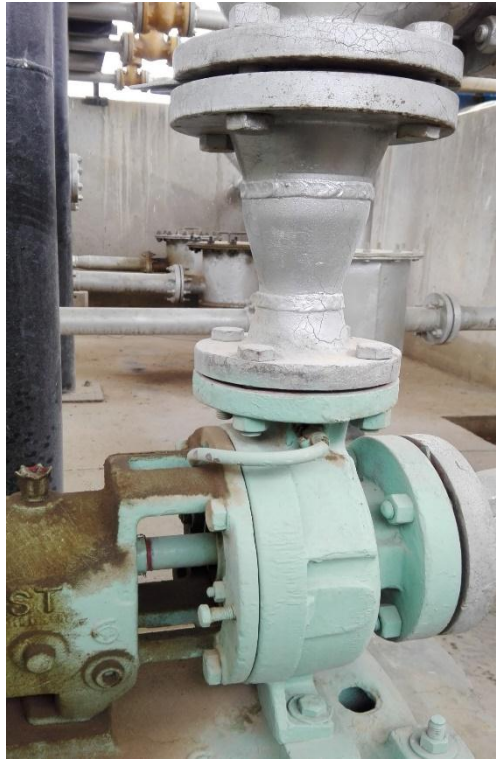
ANEXO 17: Electrobomba centrifuga ingersoll-rand N° 3
