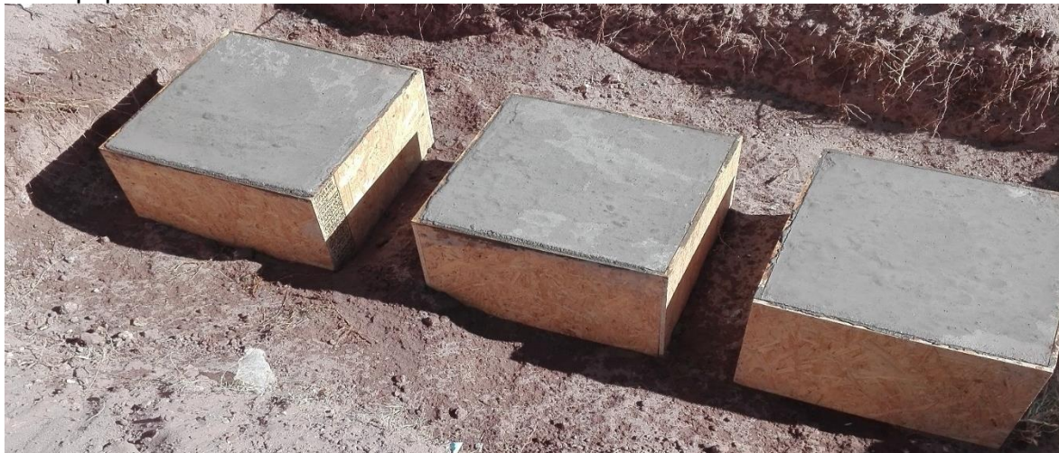
FOTOGRAFIA 4: Vaciado de solado en la cara superior del espécimen e Instalación del equipo de corte insitu.
