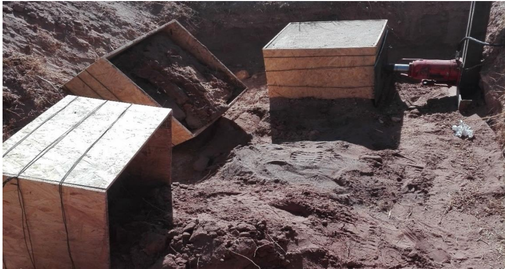
Figura N° 22: Falla del suelo.
