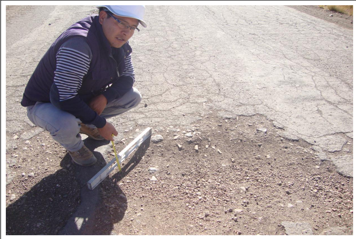
FOTOGRAFIA N° 10 PERDIDA DE AGREGADOS, HUECOS, BACHES
