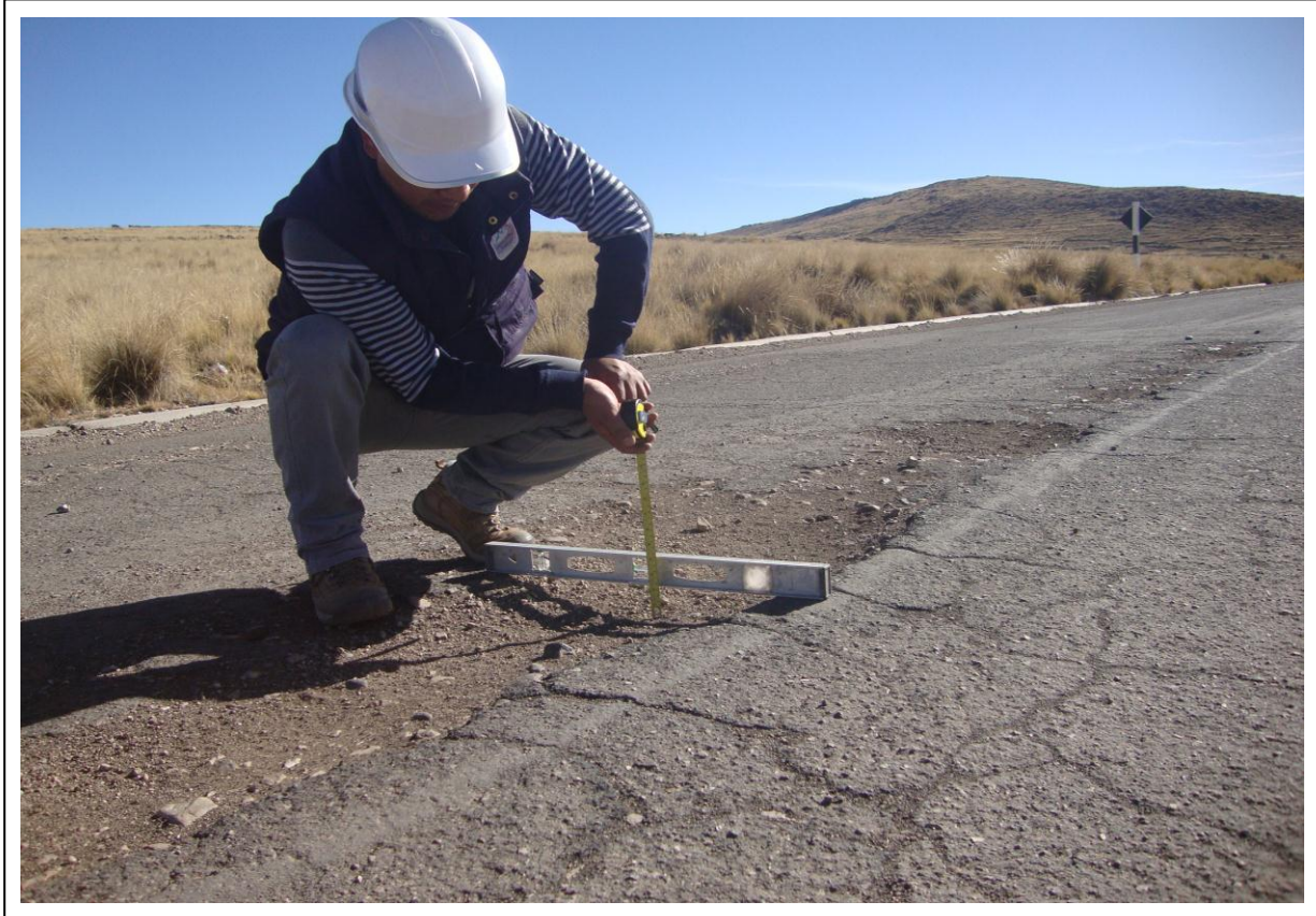
FOTOGRAFIA N° 11 PERDIDA DE AGREGADOS, HUECOS, BACHES
