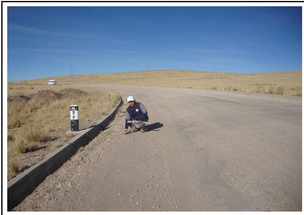
Figura III. 5. Socavación en cuneta sin revestir que reduce la sección de la vía
