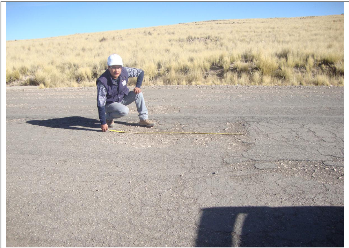
FOTOGRAFIA N° 04 FALLA POR HUNDIMIENTO
