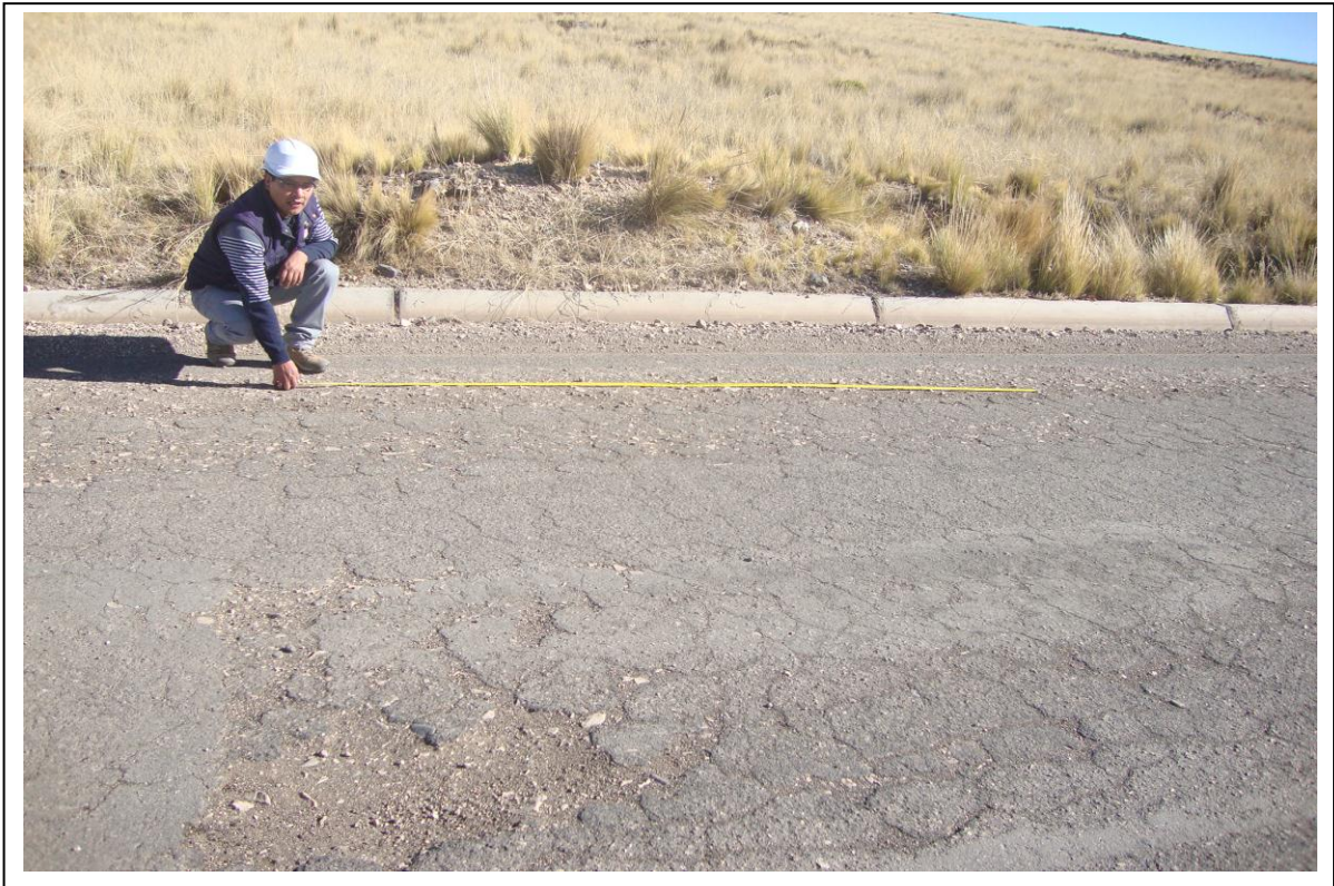
FOTOGRAFIA N° 08 FISURAS LONGITUDINALES POR FATIGA
