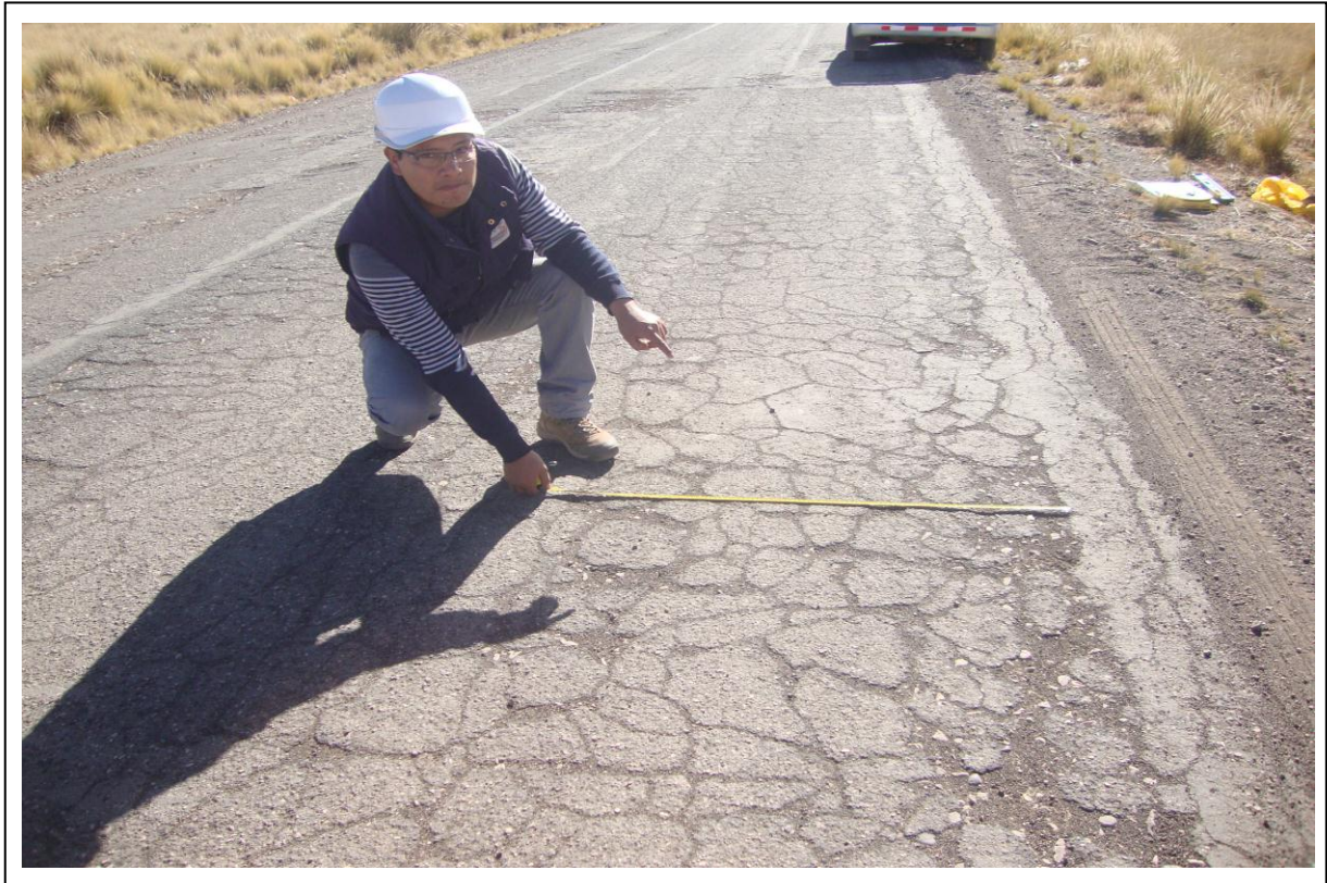
FOTOGRAFIA N° 05 FISURAS DE PIEL DE COCODRILO
