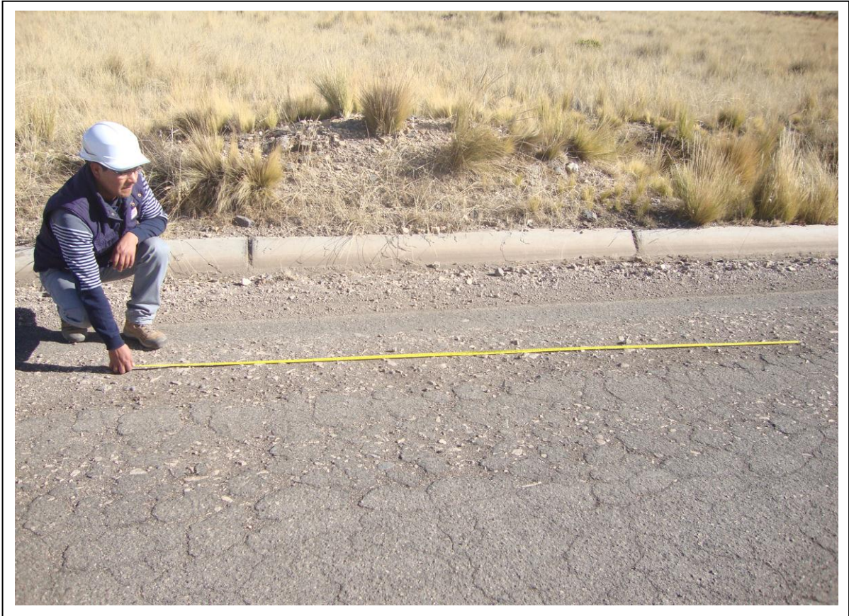
FOTOGRAFIA N° 07 FISURAS LONGITUDINALES POR FATIGA
