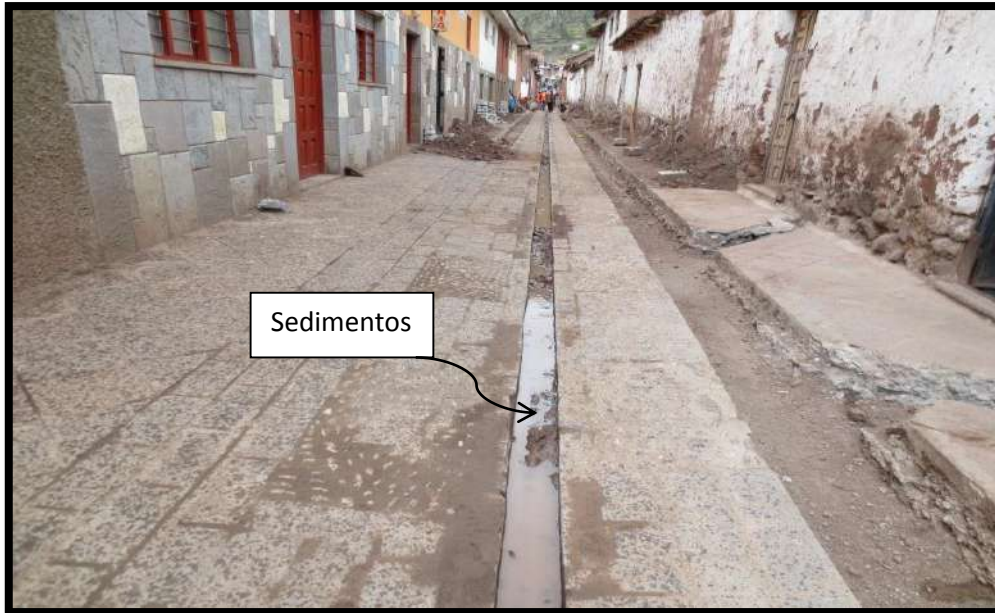
Fig. N° 6: Calle Pardo de la ciudad de Písaq con problemas de Drenaje sedimentación de arrastres arenas.
