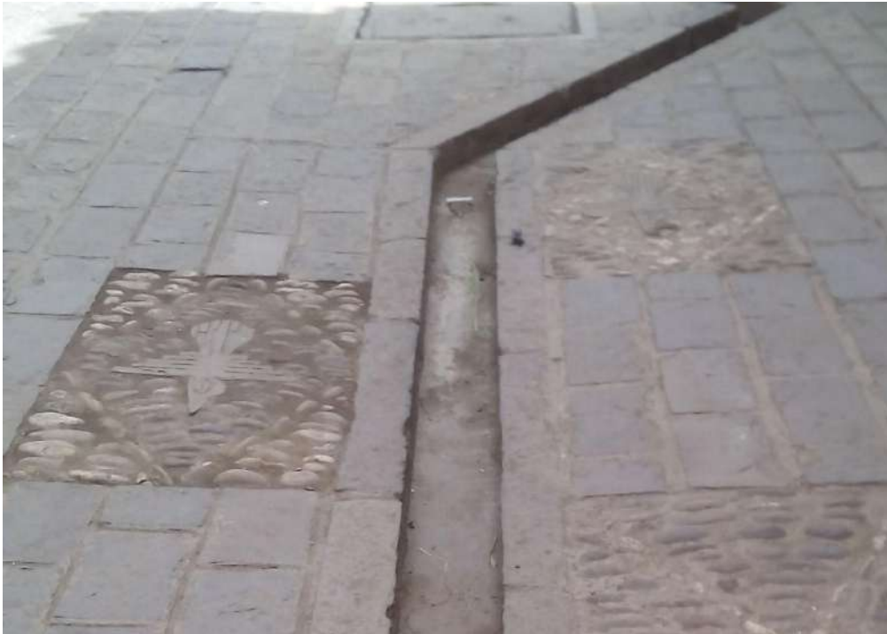
Fig. N° 14: Canal De Drenaje Existente Con Secciones Muy Pequeñas.
