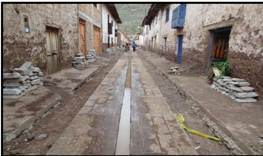
Fig. N° 5: Calle Vigil de la ciudad de Písaq, con problemas de drenaje estanque de aguas residuales.
