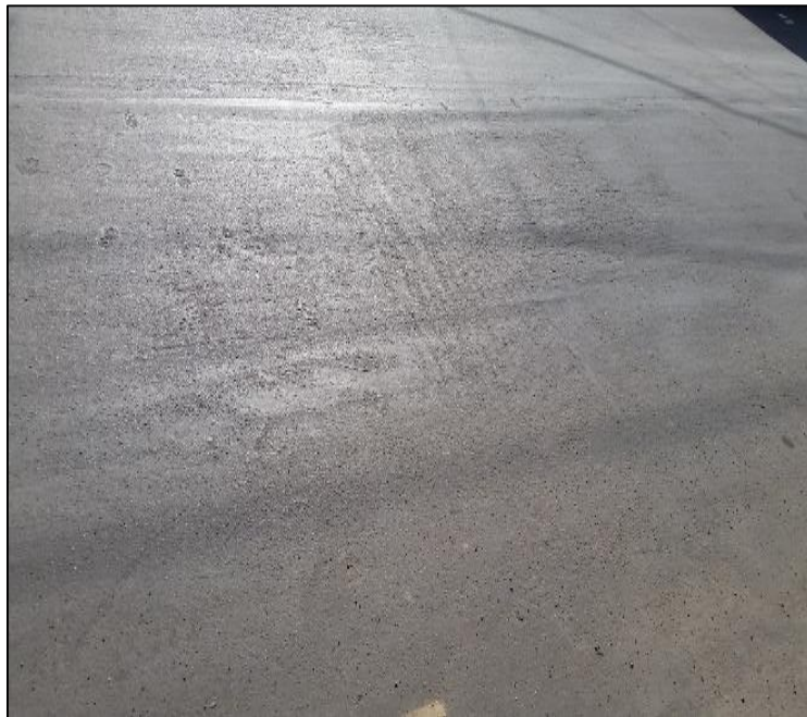
Figura 08: Desnivel entre pavimento existente y nuevo
