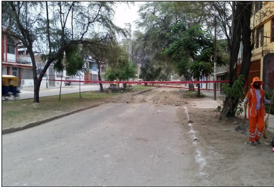
Figura 11: Definido los tramos y secciones a rehabilitar se procede hacer cortes y escarificado del pavimento.
