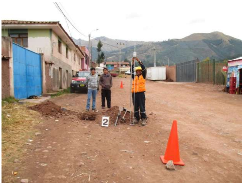
Figura N° 13 - POZO N° 02 Vista del Ensayo de PDL In Situ realizado en la calicata.
