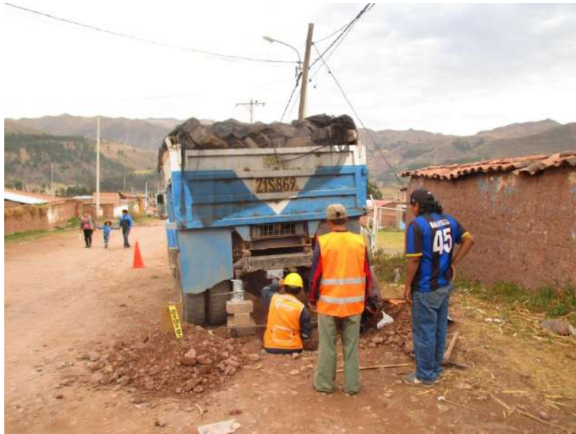
Figura N° 15 - POZO N° 02 Vista del Ensayo de CBR In Situ realizado en la calicata.
