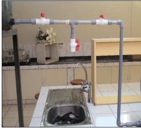
Figura 3.21: Acoplamiento de tuberías al reactor
