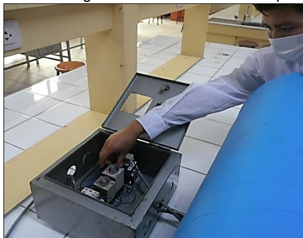
Figura 3.31: Programación del Tablero Temporizador
