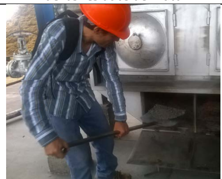
Recojo de las cenizas del depósito del caldero
