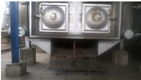
Depósito del caldero donde se recolectan las cenizas
