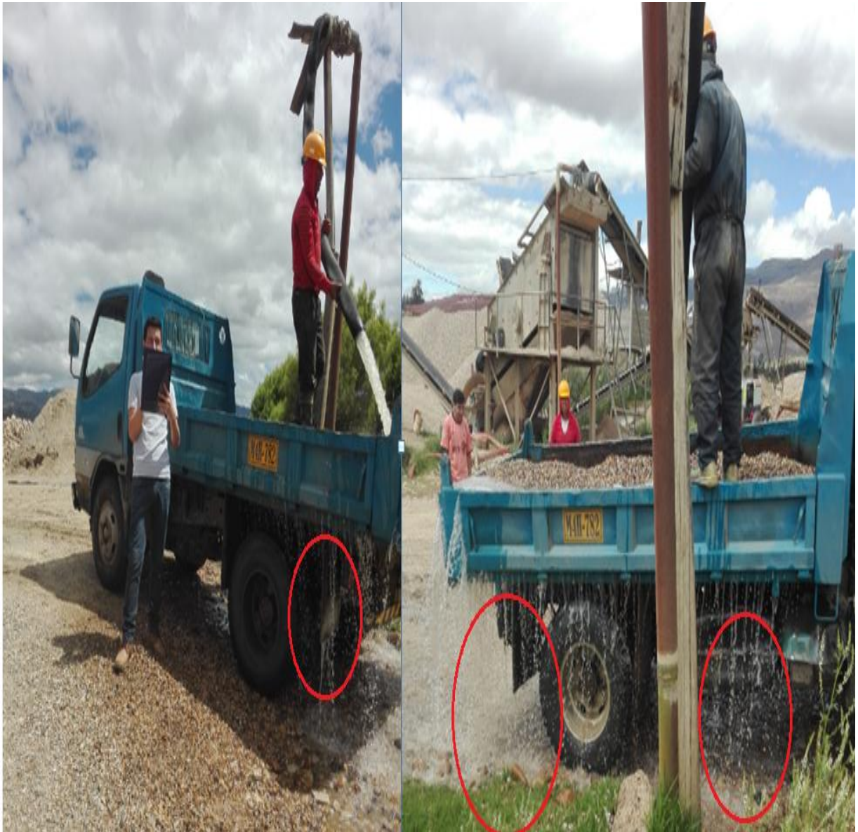
Figura 45. Lavado del hormigón sin EPP. Fuente: Elaboración propia, 2017.
