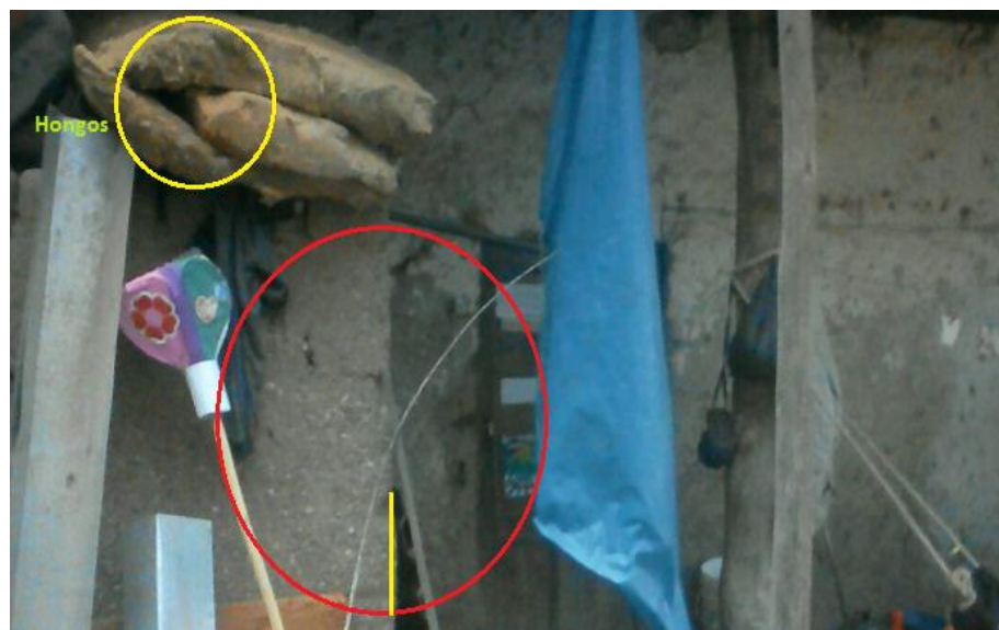
Figura 34: Impacto por humedad en vivienda B Fuente: Elaboración propia, 2017.
