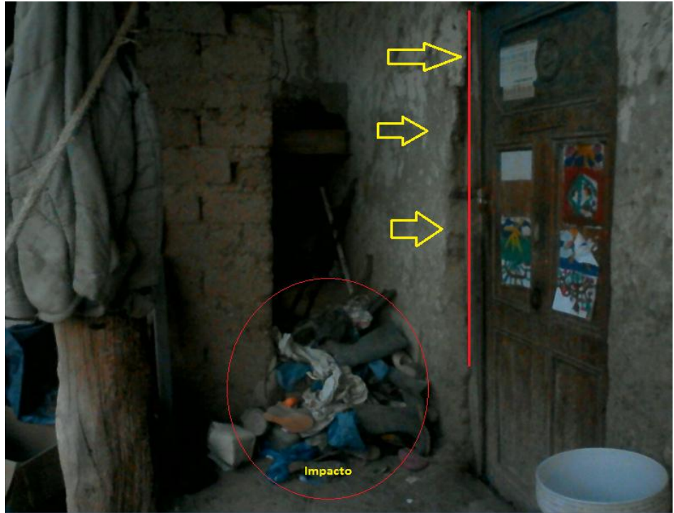
Figura 33: Impacto por humedad en la vivienda A Fuente: Elaboración propia, 2017.
