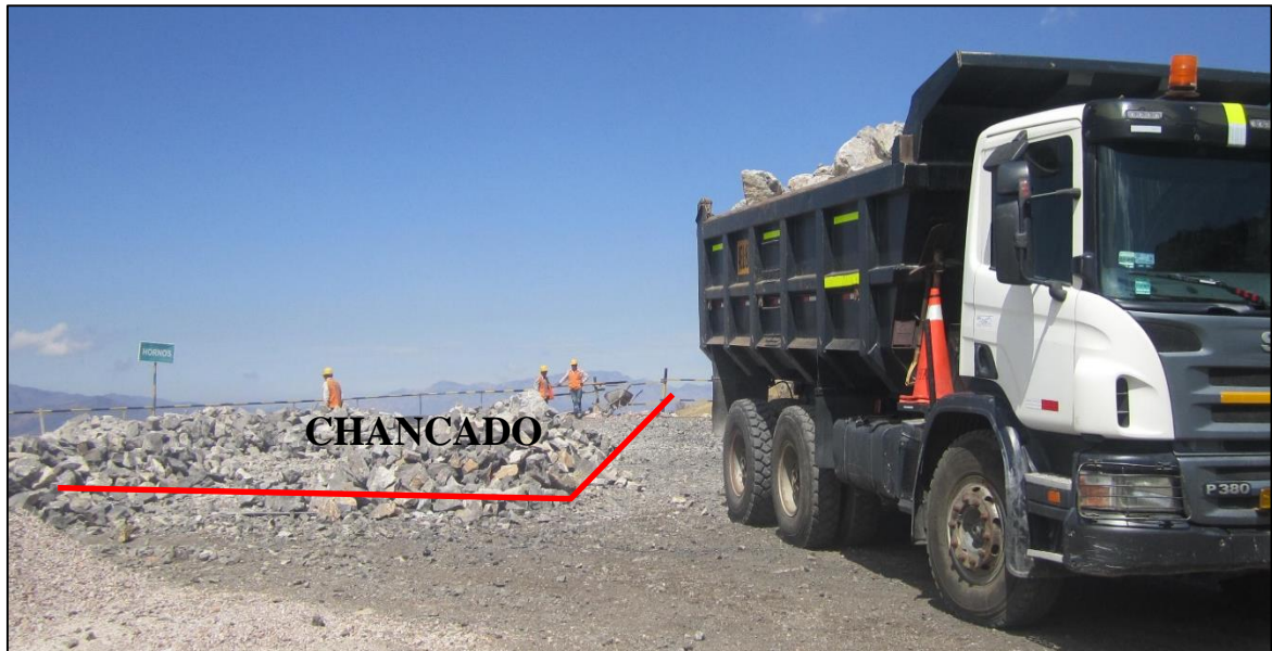
Figura 15: Zona de chancado de caliza.
