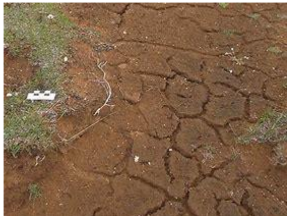
Grietas perpendicular al eje de calzada
