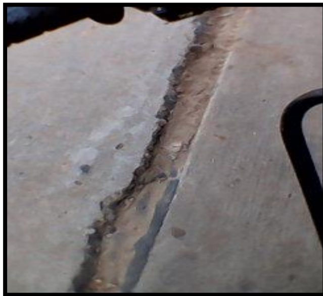
Foto N° 18: Deterioro longitudinal profundo, cuadra 15
