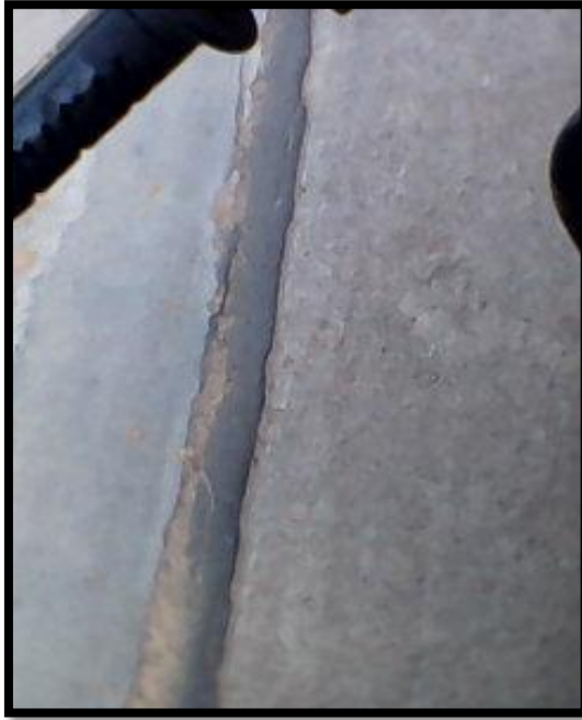
Foto N° 17: Deterioro longitudinal parchado, cuadra 15
