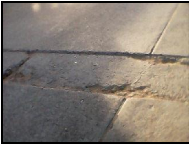
Foto N° 08: baches perpendiculares, cuadra 9
