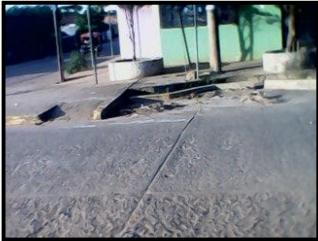
Foto N° 13: Inicio del resquebramiento, cuadra 19
