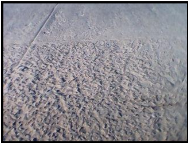
Foto N° 14: Deterioro tipo raspado cuadra 4
