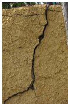
Grietas de esquina
