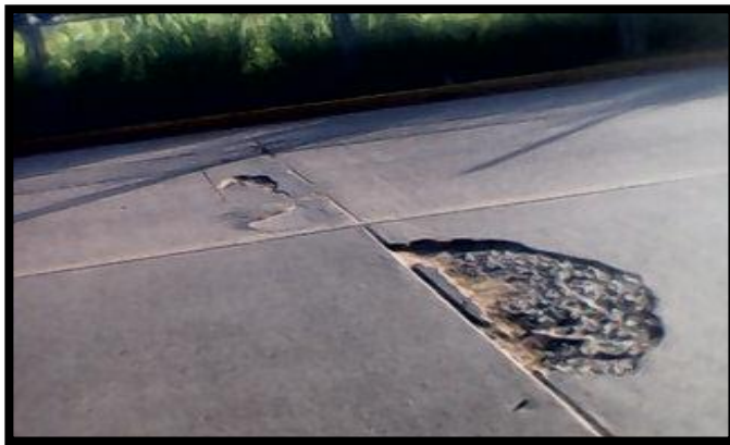
Foto N° 04: Deterioro tipo baches, cuadra 22
