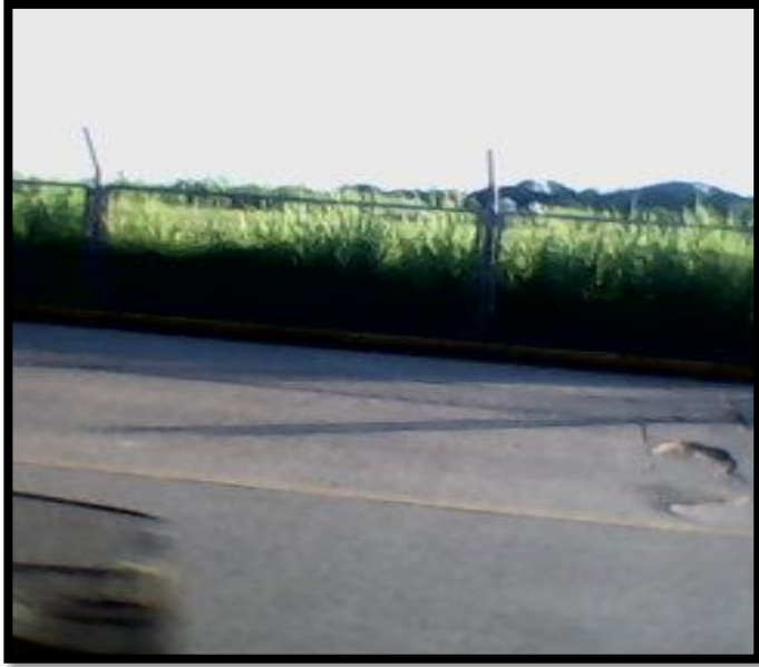
Foto N° 05: Deterioro, cuadra 4: frente al aeropuerto
