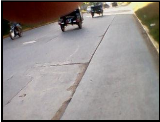
Foto N° 03: Pequeños deterioros transversales, cuadra 12
