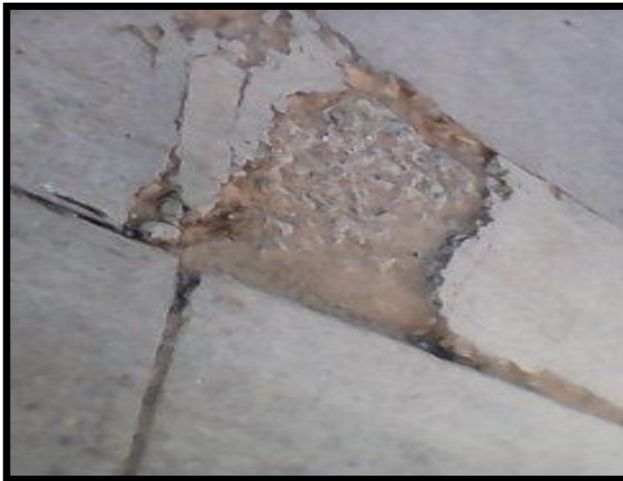
Foto N° 02: Deterioro de baches, cuadra 5
