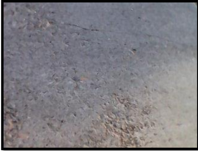
Foto N° 12: Resquebramiento del pavimento, cuadra 29
