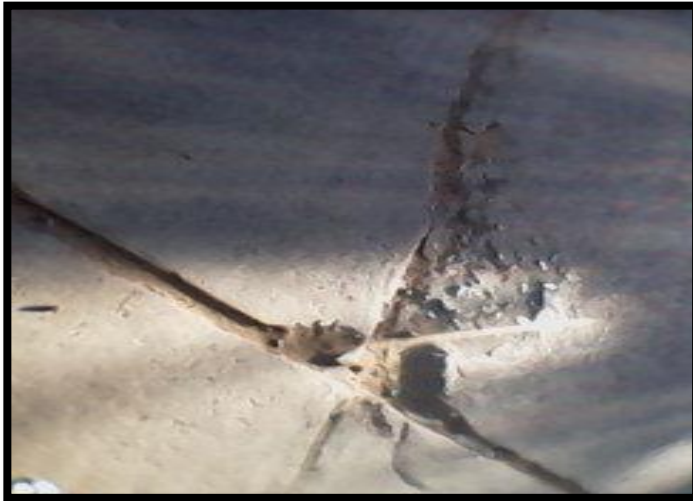
Foto N° 01: Deterioro de juntas., Cuasrda 1
