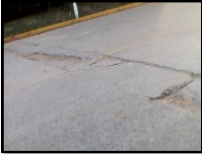
Foto N° 09: Inicio de los deterioro en las juntas, cuadra 38
