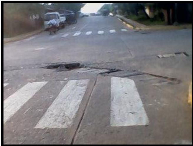
Foto N° 11: Deterioro en cunetas, cuadra 27
