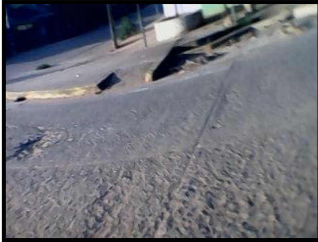
Foto N° 15: Deterioro más pronunciado, cuadra 15
