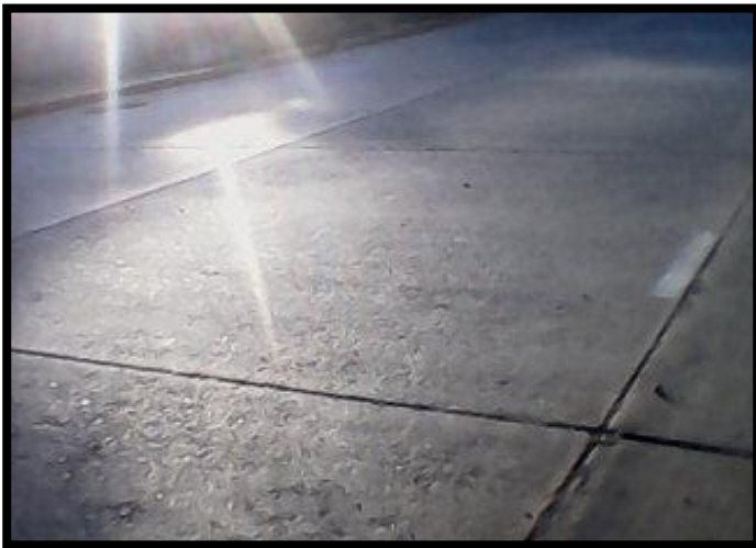
Foto N° 06: Inicio de los deterioros, cuadas 6
