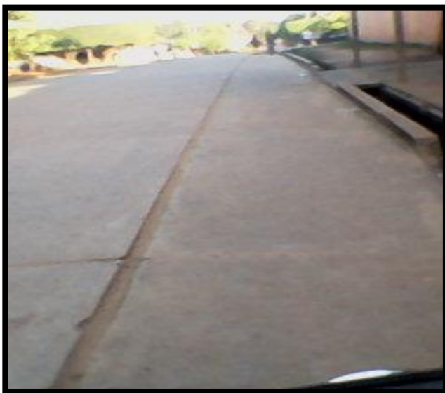
Foto N° 16: Deterioro longitudinal de las juntas, cuadra 12
