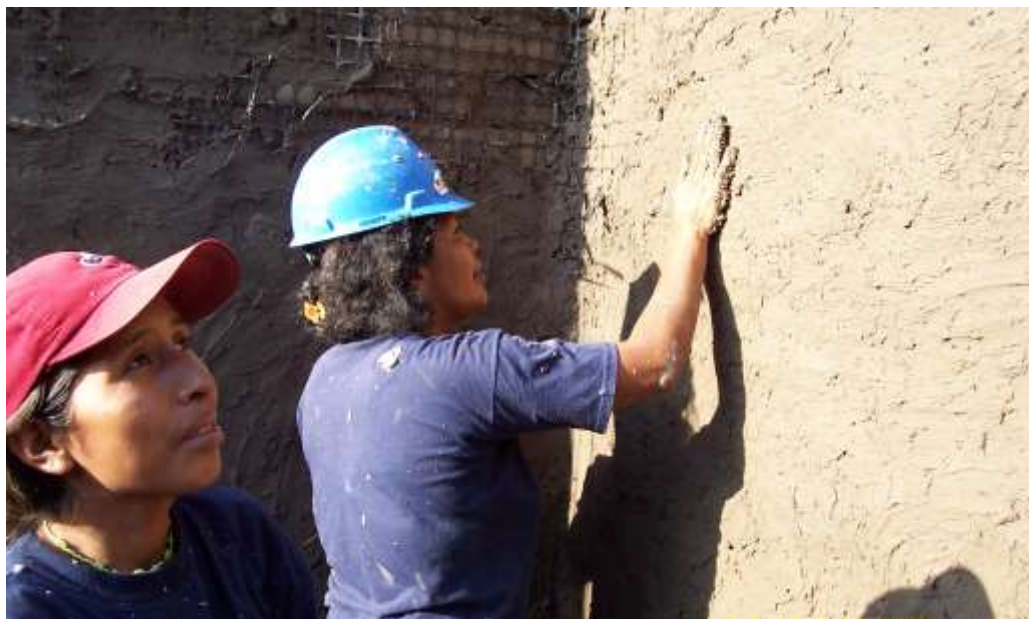
Figura N° 13: Capas de tarrajeo
