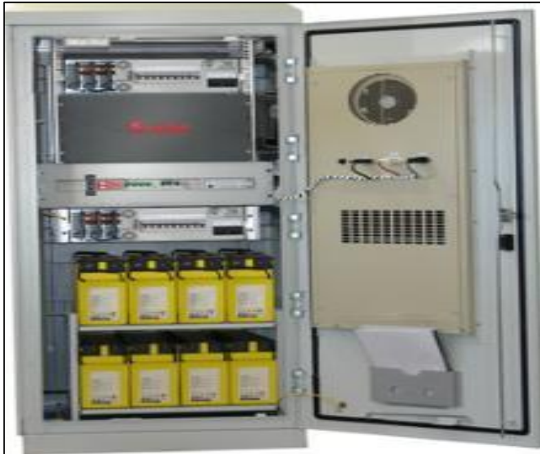
Figura 22: Banco de baterías.
