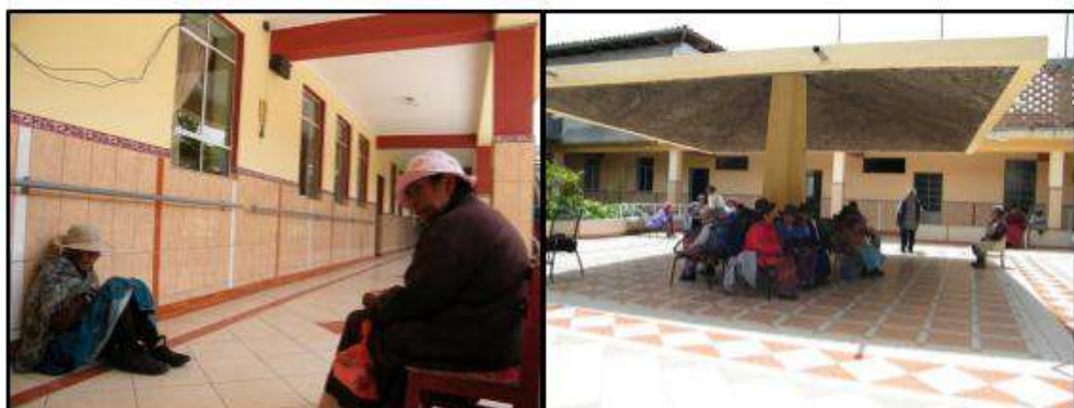
Inadecuadas y deficientes condiciones arquitectónicas de ambientes de descanso.
