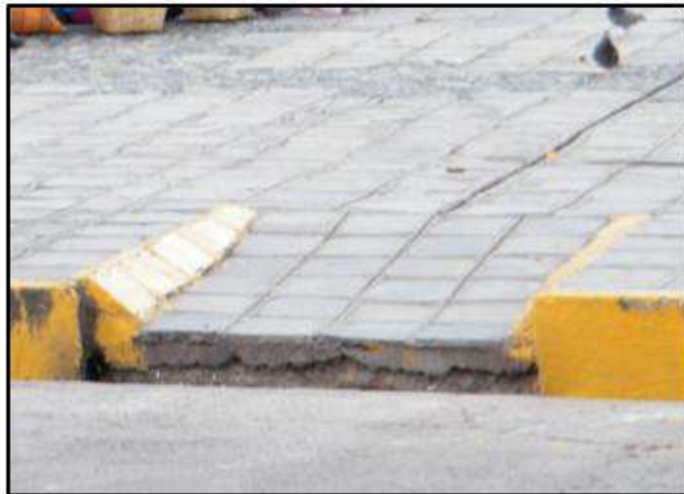
Imagen 12: Rampas de Plazas en mal estado
