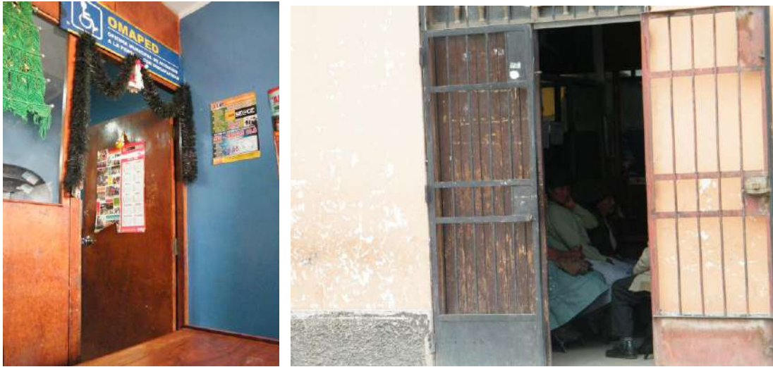
Imagen 03: oficinas de CIAM y OMAPED, improvisadas e inadecuadas
