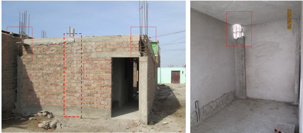
Ilustración N°14 , Se observa en la imagen Izquierda, la vivienda con sistema de albañilería confinada que no cumple, con la disposición adecuada de columnas, ni lo dispuesto en la E. 070 – CAPITULO 4 – Procedimientos de Construcción, Albañilería Confinada, ya que las columnas no se encuentran culminadas. Ilustración N°15 , En la imagen Derecha, muestra el interior del Ambiente, la armadura de acero expuesta, lo cual debilita considerablemente el sistema estructural de la vivienda, generando riesgo. Fuente: Fuente Propia.
