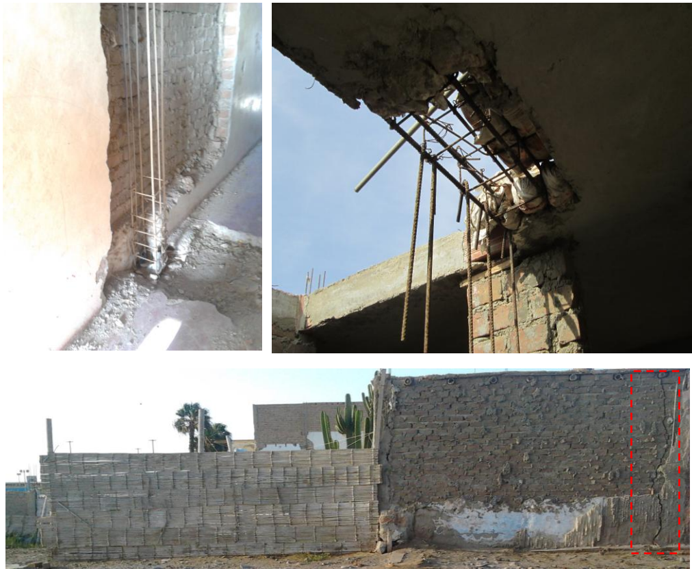
Ilustración N16 , Imagen Izquierda, observa la armadura de acero expuesta del elemento estructural, no presenta amarre definido, lo cual hace muy peligroso para ser habitado por las familias. Ilustración N°17 , Imagen Derecha, muestra armadura de acero expuesta de la losa de concreto, esto genera el deterioro de la armadura debilitando y ocasionando el inadecuado funcionamiento estructural. Ilustración N°18 , Imagen Inferior, observa fisura, en el Muro, ya que no presenta confinamiento debido a la falta de columnas de amarre, ello se debe a la inadecuada disposición o ubicación de las mismas. Fuente: Fuente Propia.
