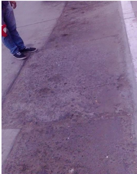
FOTOGRAFÍA 05, PARCHE DETERIORADO – JIRON AREQUIPA CUADRA 3
