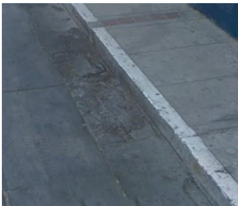
FOTOGRAFÍA 12, PARCHE DETERIORADO – JIRON AREQUIPA CUADRA TRES
