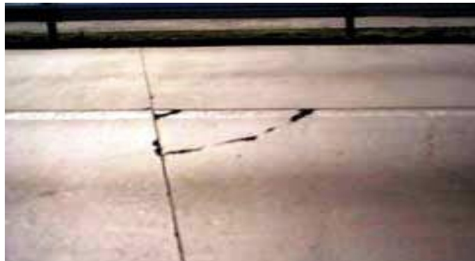
Imagen 12: Fisura de esquina
