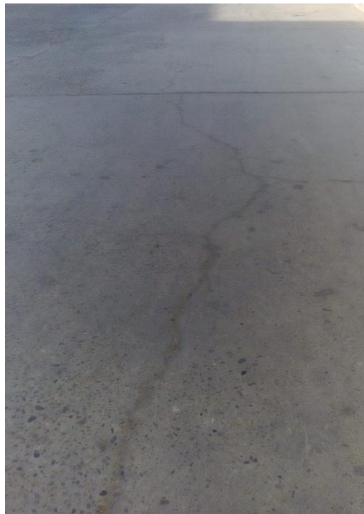
FOTOGRAFÍA 08, FISURA LONGITUDINAL – JIRON AREQUIPA CUADRA TRES
