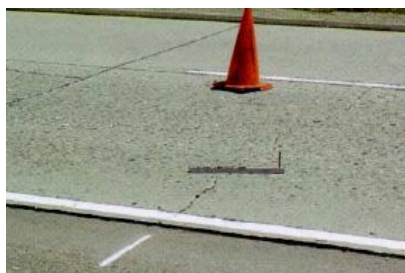
Imagen 10, Fisura longitudinal o diagonal- Fuente: Ing. Luis F. Altamirano Kauffmann 2007
