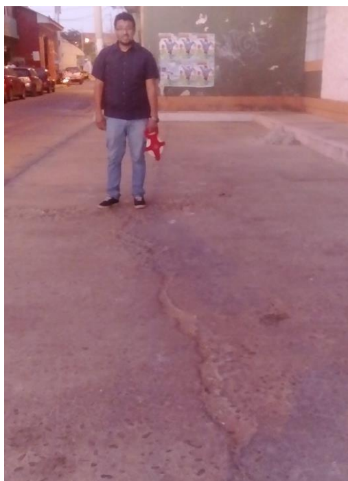
FOTOGRAFÍA 02, FISURA LONGITUDINAL – JIRON AREQUIPA CUADRA 2- FUENTE PROPIA
