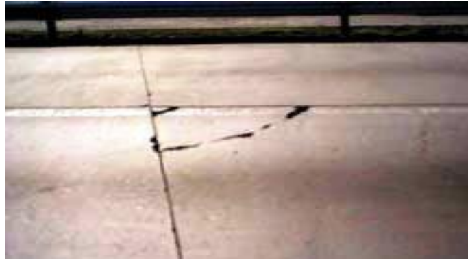
Imagen 12: Fisura de esquina- Fuente: Ing. Luis F. Altamirano Kauffmann 2007
