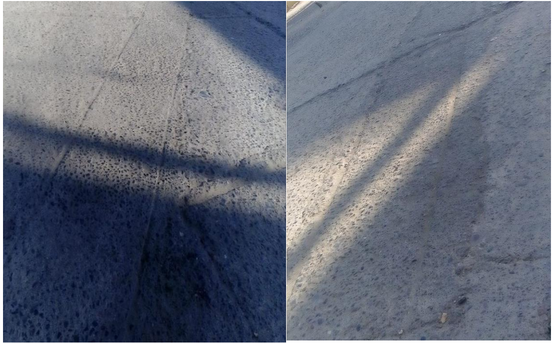
FOTOGRAFÍA 09, FISURA CAPILAR – JIRON AREQUIPA CUADRA TRES
