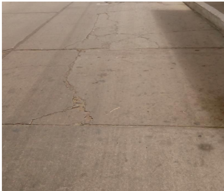
FOTOGRAFÍA 06, FISURA LONGITUDINAL – JIRON AREQUIPA CUADRA 2 - FUENTE PROPIA
