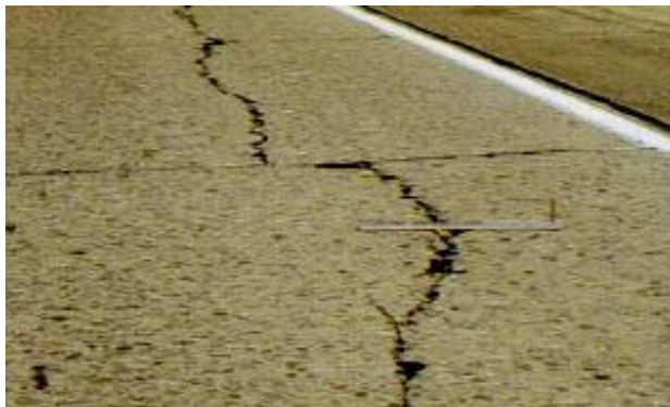
Imagen 11: Fisura longitudinal - Fuente: Ing. Luis F. Altamirano Kauffmann 2007
