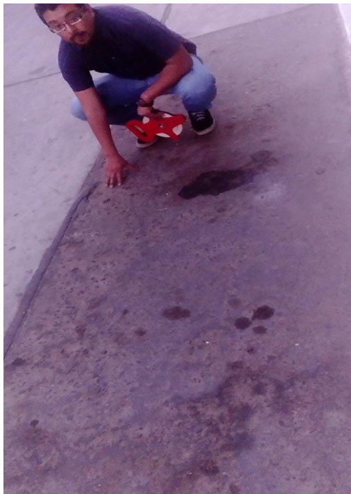
FOTOGRAFÍA 06, PARCHE DETERIORADO – JIRON AREQUIPA CUADRA 3-
