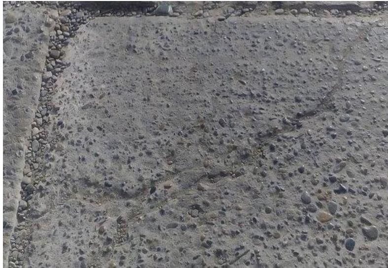
FOTOGRAFÍA 03, FISURA DE ESQUINA – JIRON AREQUIPA CUADRA 2- FUENTE PROPIA
