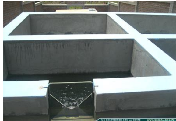
Foto 07: Planta de Tratamiento Simbal. Autor: Municipalidad Distrital de Simbal.
