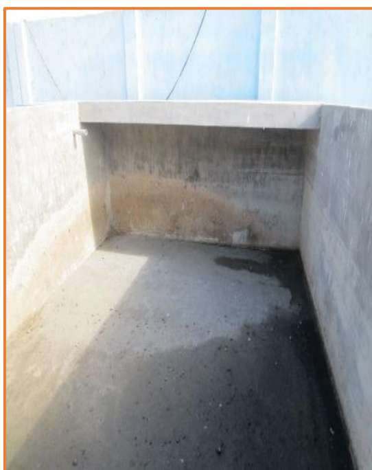
Área de almacenamiento de agua de limpieza Desembarcadero Pesquero Artesanal de PARACHIQUE
