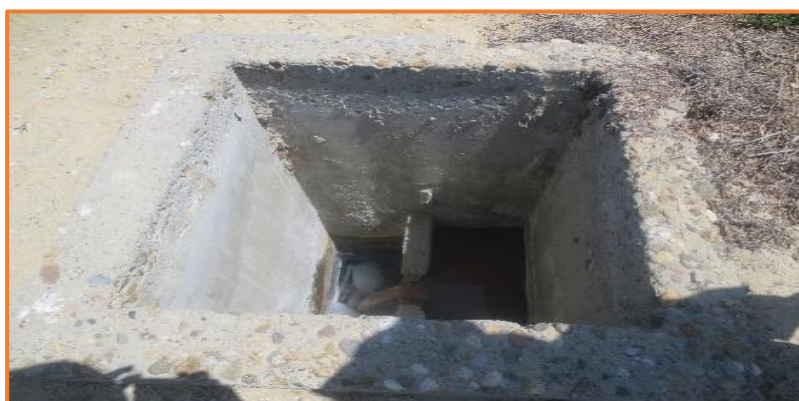
Foto N°: Caja se registró de la salida de la laguna de oxidación de la Municipalidad distrital de Rinconada Llicuar
