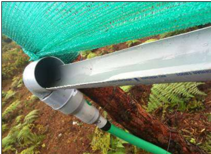
Fotografía N° 07: Colector conectado al sistema del tanque de almacenamiento.
