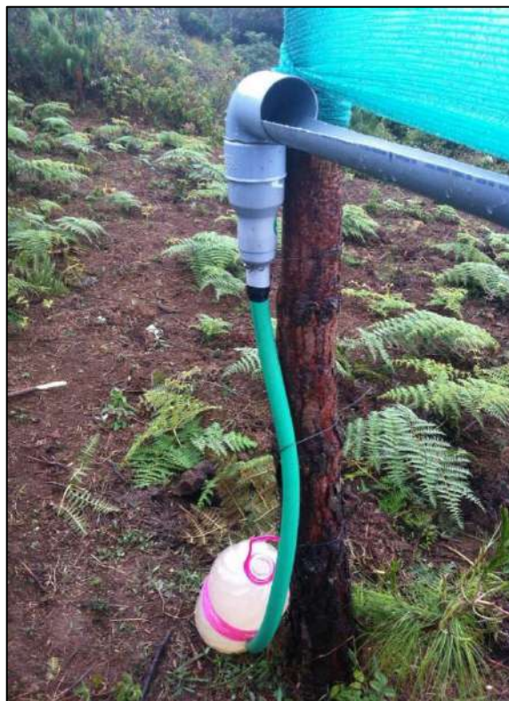
Fotografía N° 13: Sistema de recolección del agua al tanque de almacenamiento
