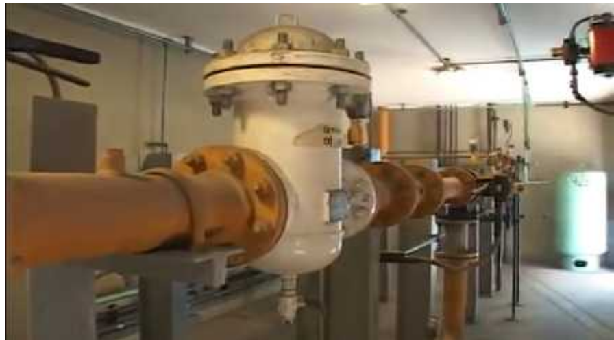
Figura 47. Instalación de gas natural en el área de fundición Minsur. Fuente: Elaboración propia, 2016.
