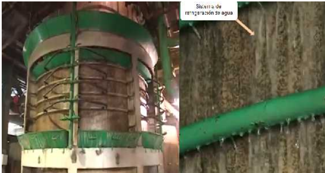
Figura 45. Sistema de refrigeración horno planta de fundición Sn- Minsur. Fuente: Datos estadísticos de cartilla observador, 2016.
