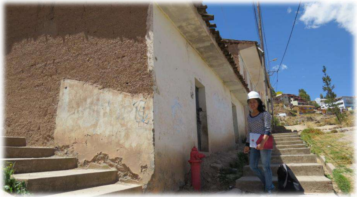
Figura 54 Estado actual de la Vivienda en Apv Mosocllacta.
