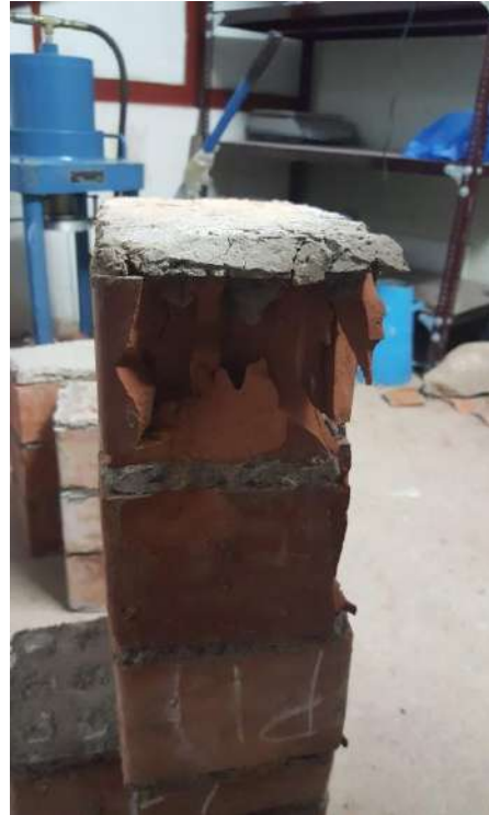
Presenta falla explosiva y falla de aplastamiento.
