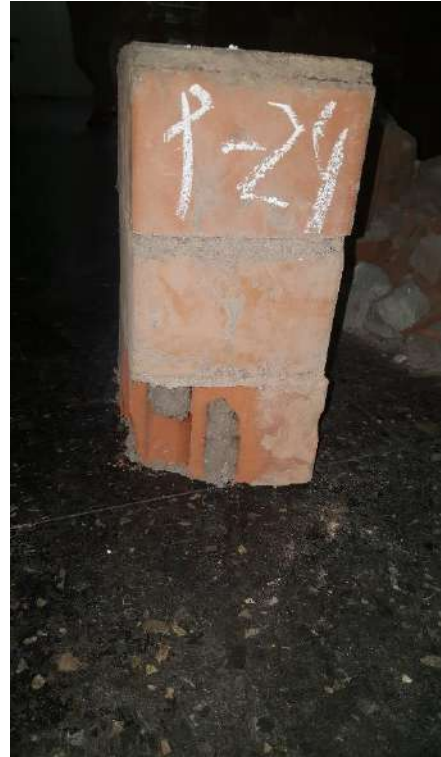
Presenta falla de aplastamiento.
