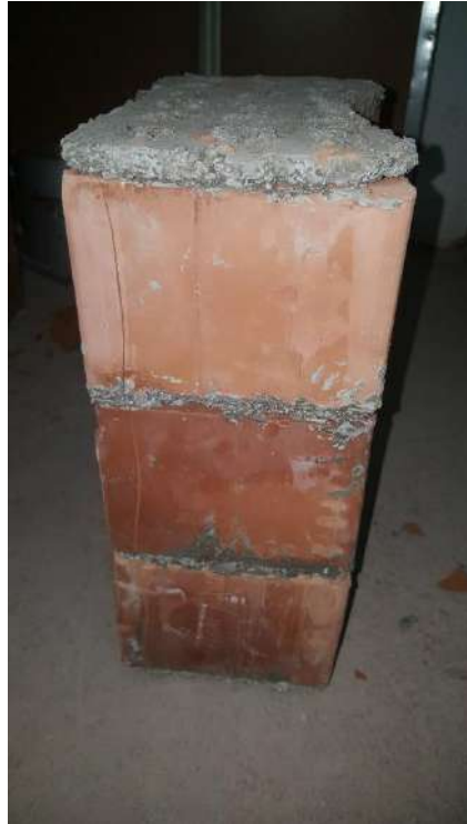
Presenta falla vertical.
