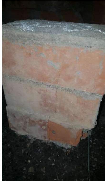
Presenta falla vertical y falla de aplastamiento.
