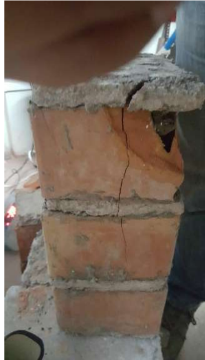
Presenta falla vertical y falla explosiva
