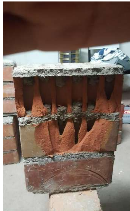
Presenta falla explosiva.
