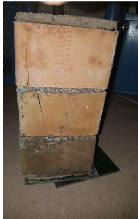
Presenta falla vertical.
