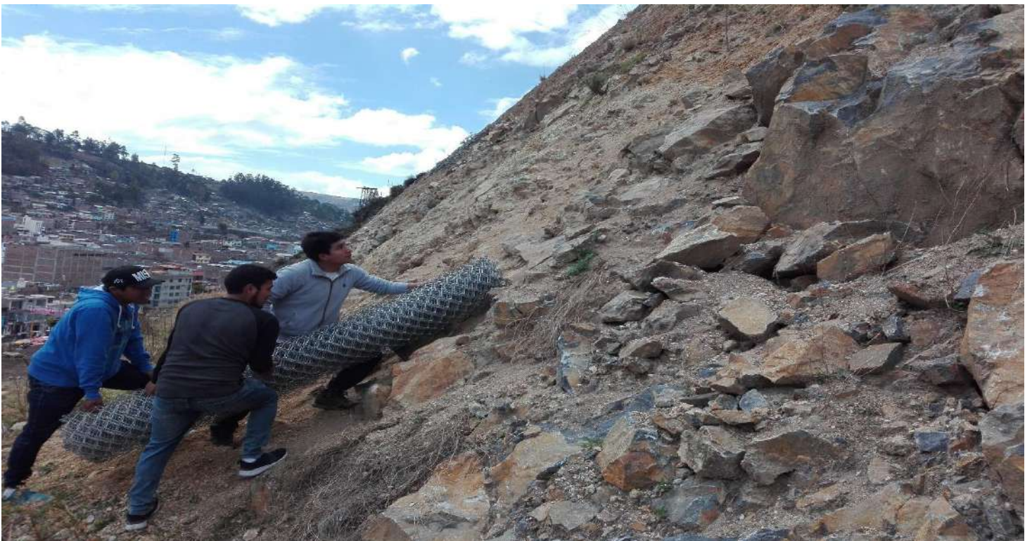
Fotografía N°30: vista de la malla propuesta como alternativa de solución insitu
