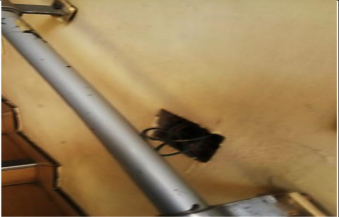
Foto N° 09: Imagen donde se muestra tomacorriente sin protección y expuestos los conductores eléctricos.
