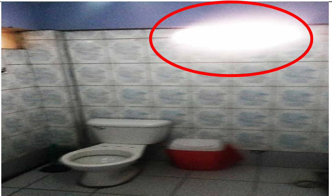
Foto N° 06: Imagen donde se muestra la ventilación obstruida del baño del segundo nivel.
