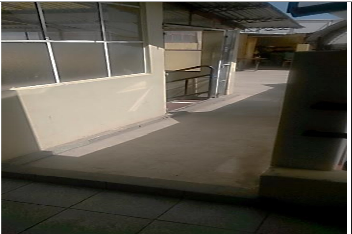
Foto N° 12: Imagen donde se muestra desnivel de piso en el quinto nivel
