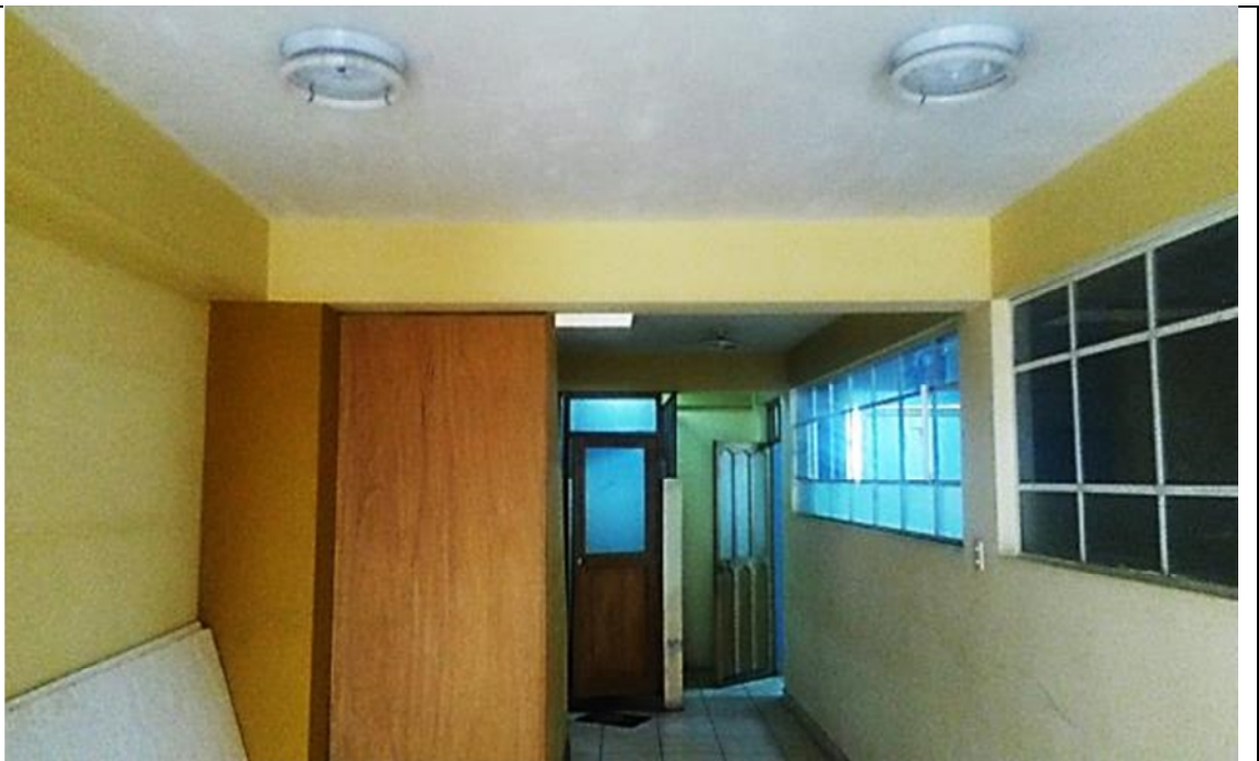
Foto N° 10: Imagen donde se muestra no cuenta con pantalla protectora las luminarias
