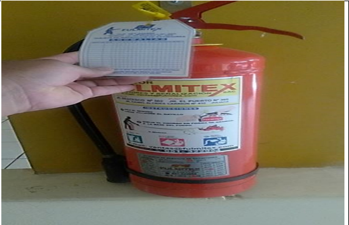
Foto N° 11: Imagen donde se muestra no cuenta con un programa de control y mantenimiento, falta la numeración de extintor.
