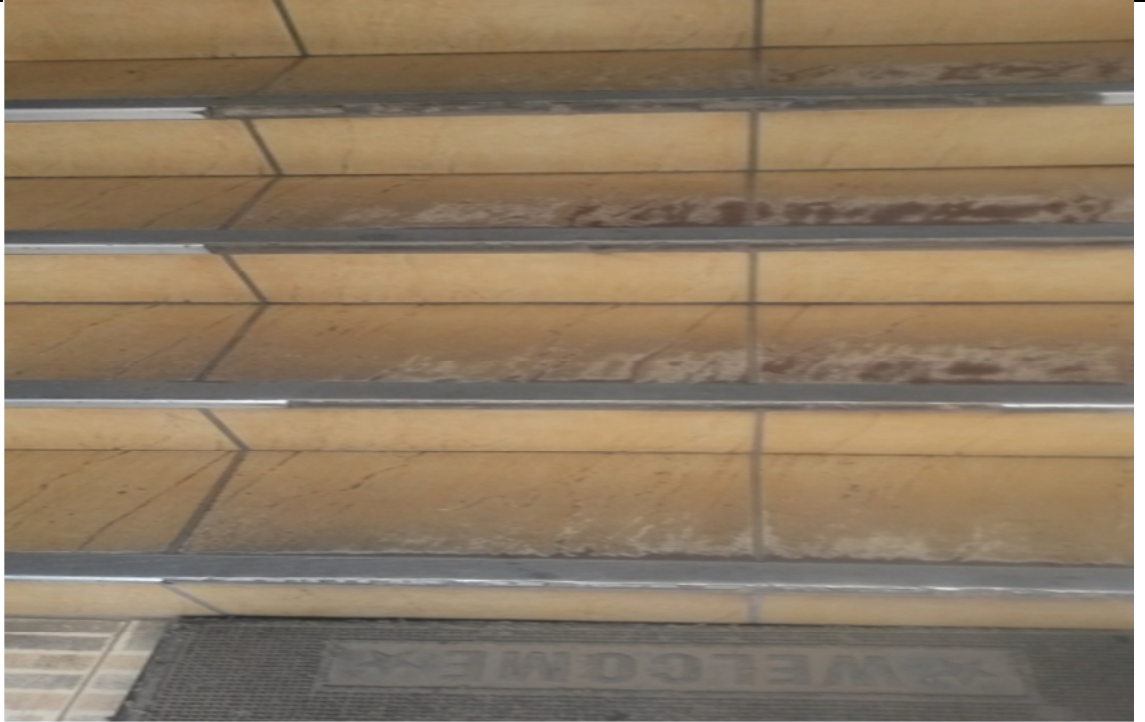
Foto N° 05: Imagen donde se muestra el deterioro de las cantoneras del primer al segundo nivel
