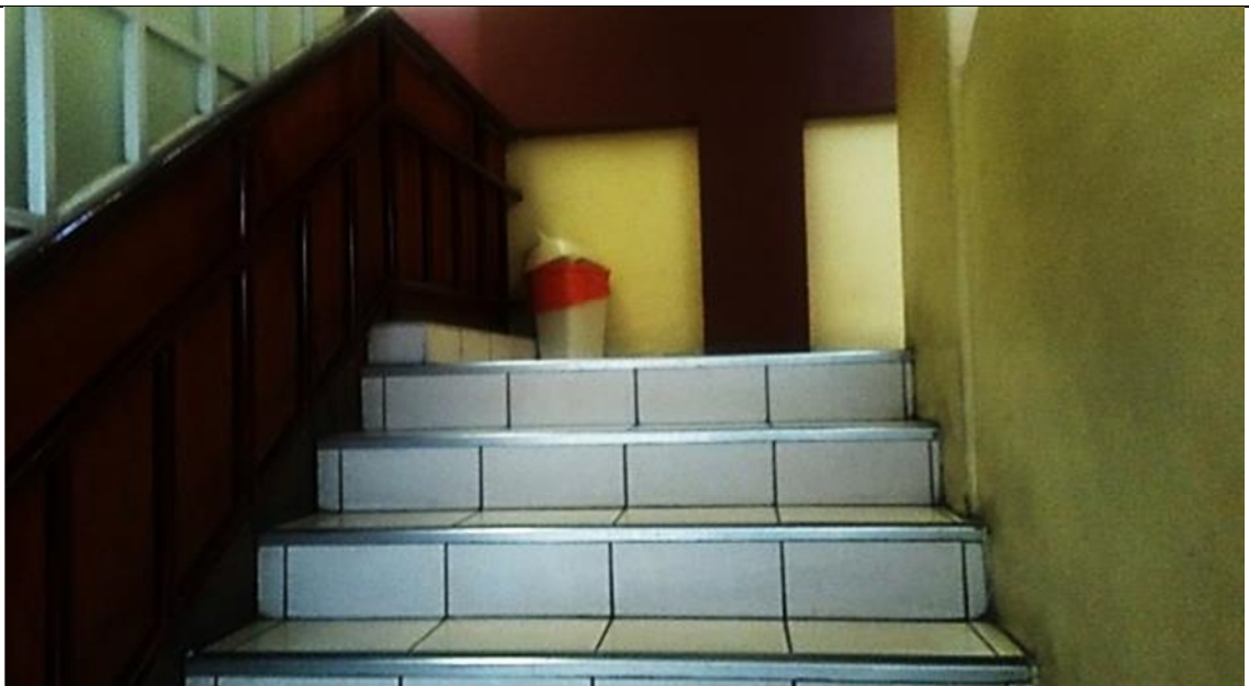
Foto N° 04: Imagen donde se muestra no cuenta con pasamanos el lado derecho tramo segundo nivel a tercer nivel.
