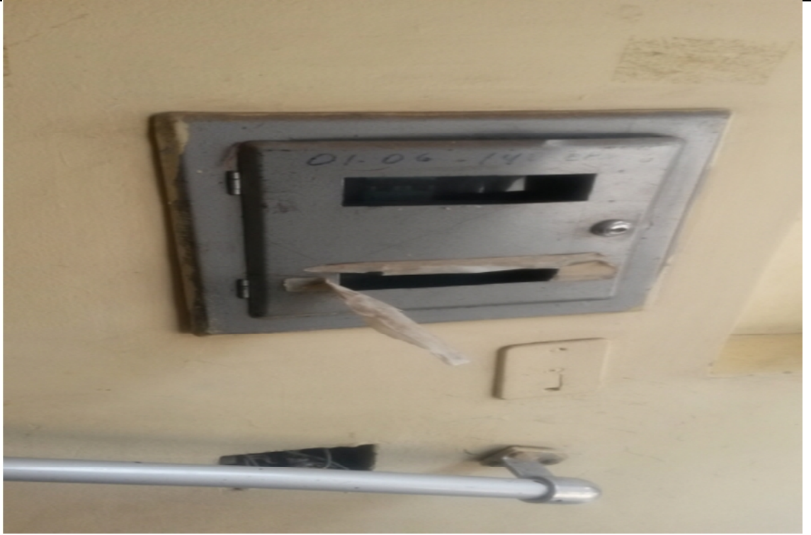
Foto N° 07: Imagen donde se muestra el deterioro del gabinete eléctrico, no cuenta con directorio de circuitos, no cuenta con mandil,
