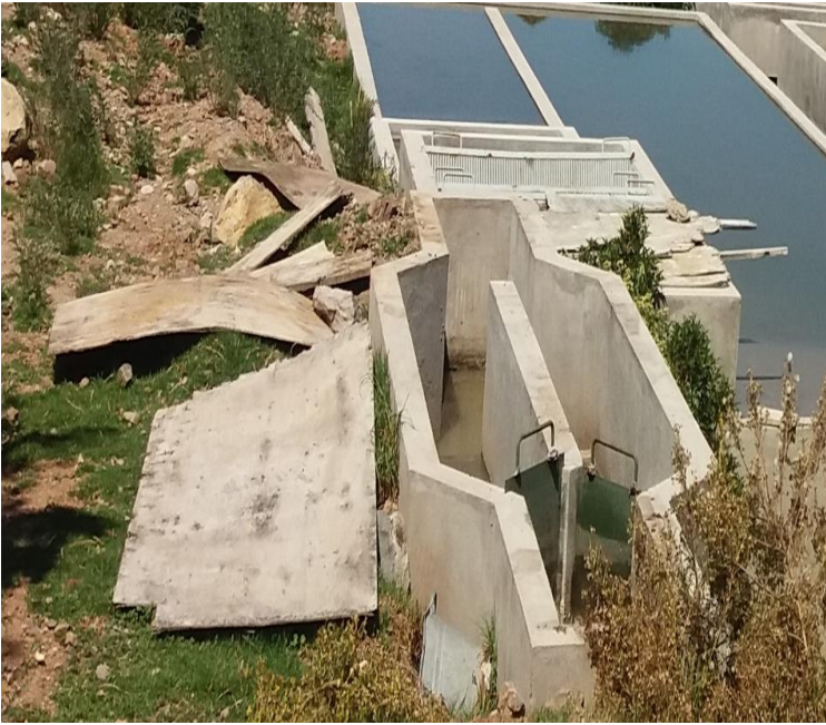
Foto 4: Pre tratamiento de la Planta de tratamiento de aguas residuales 1 – Norte
