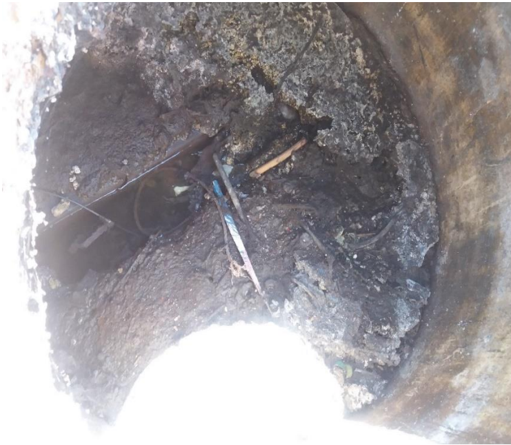
Foto 1: Buzón de la red de alcantarilla con residuos que ocasionan fugas de agua residual
