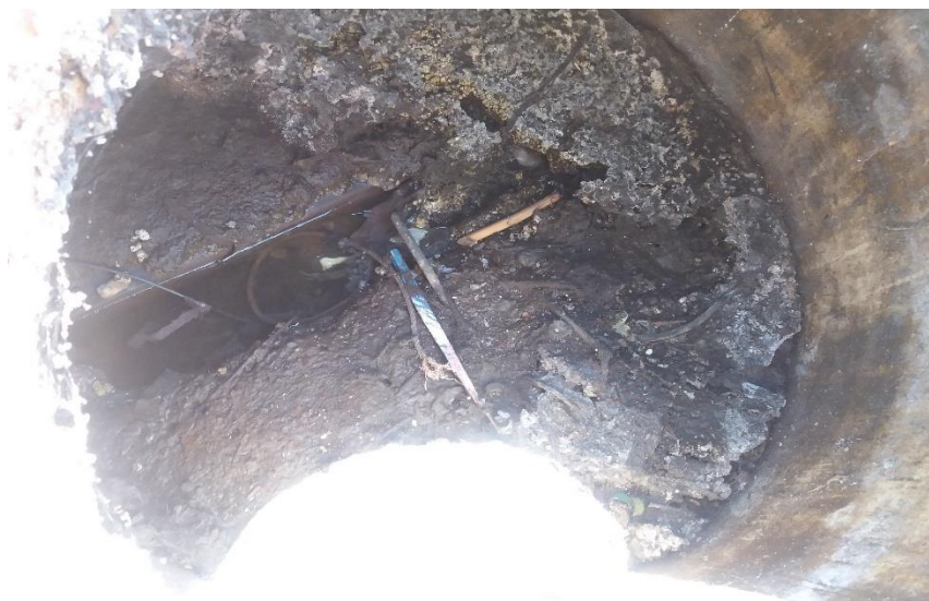
Figura 11 Presencia de sólidos, arenas, etc. En la red de alcantarillado
