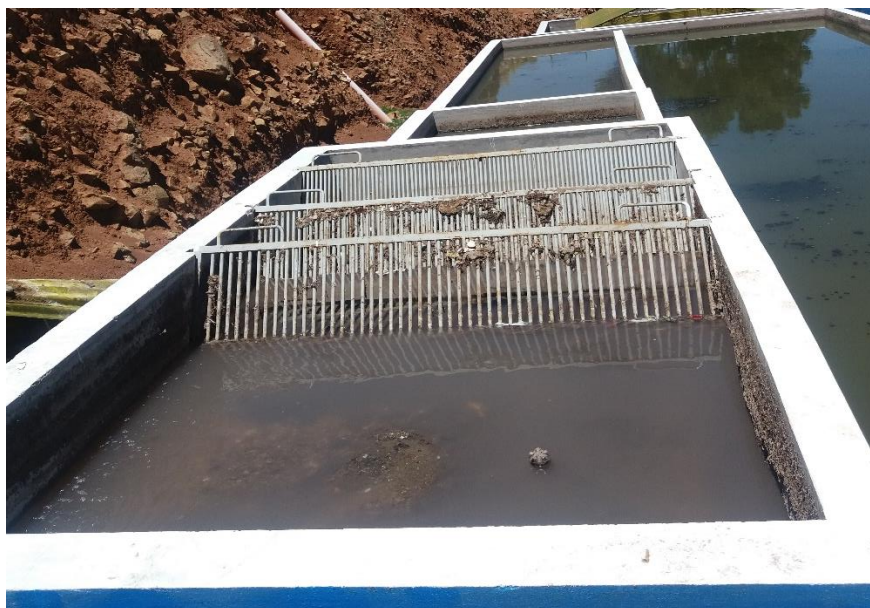
Figura 12 Presencia de sólidos en el pre tratamiento
