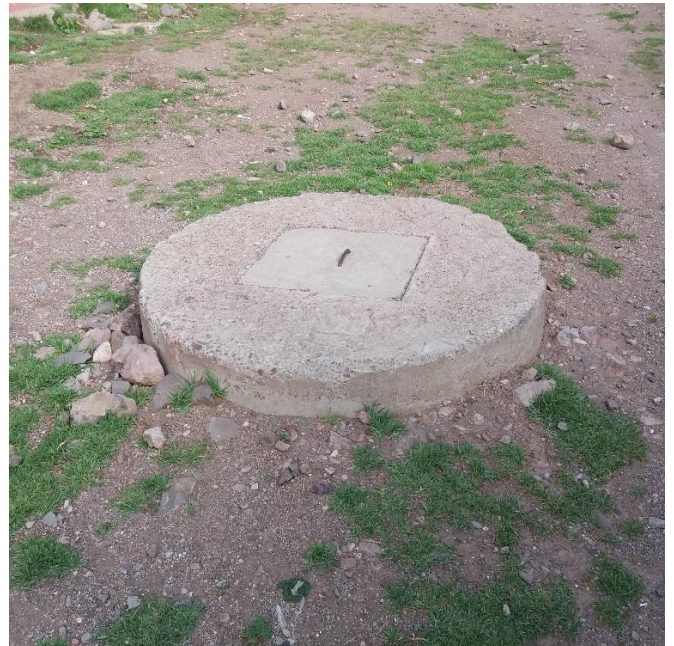
Foto 2: Buzón de red de alcantarilla en deterioro de la localidad de Chucuito
