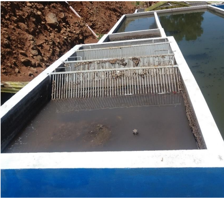
Foto 7: Pre tratamiento en la Planta de tratamiento de aguas residuales 2 – Sur
